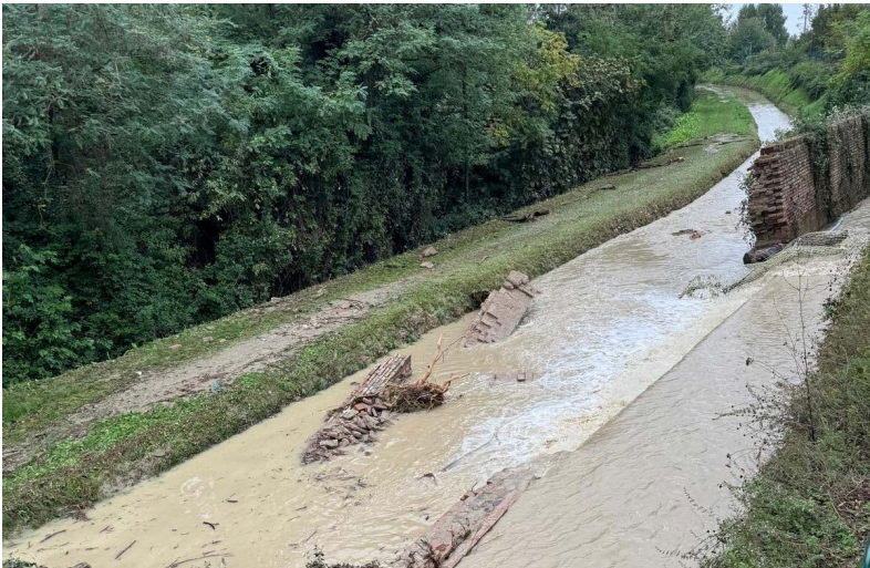
fig 24: Argine in muratura del Ravone sfondato dopo l'evento alluvionale e Canaletta Ghisiliera inondata, 20 ottobre 2024
