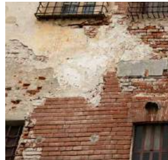
Castello di levante, fronte est, caduta totale di porzioni di intonaco e tessiture murarie prive di giunti di malta, Lagnasco, 2025.
