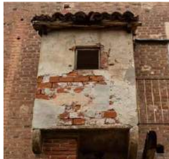
Castello di levante, piccola struttura aderente alla torre sud-est, perdita di adesione e progressivo sfogliamento dell'intonaco, Lagnasco, 2025.
