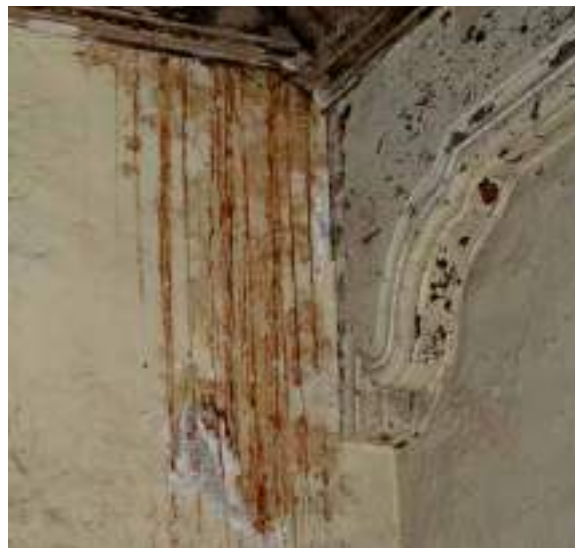
Castello di levante, colature rossicce in corrispondenza del nodo trave parete, Lagnasco, 2025.
