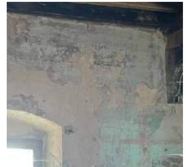
Castello di levante, esfoliazione e scagliatura della tinteggiatura con estesi distacchi, Lagnasco, 2025.
