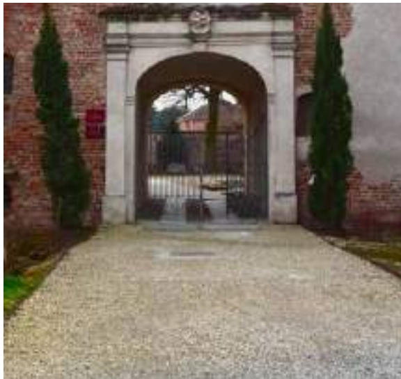
Castello levante, accesso principale alla corte interna, striscia di pavimentazione in ghiaia con presenza muschi e vegetazione sottostante, Lagnasco, 2025.
