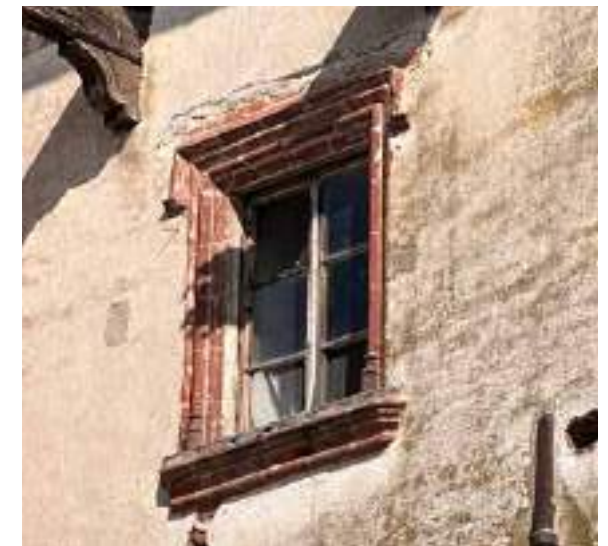
Castello di mezzo, fronte ovest, fenomeni di fessurazione e alterazione cromatica dei telai lignei, Lagnasco, 2025.
