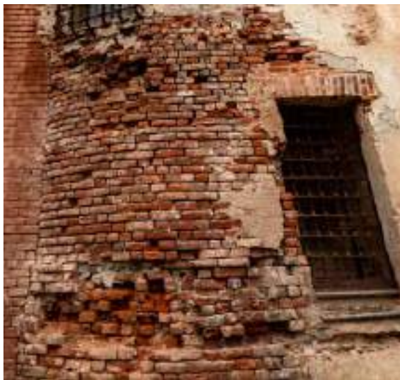
Castello di levante, torre scalare sul fronte est, perdita di elementi murari e di giunti di malta, Lagnasco, 2025.
