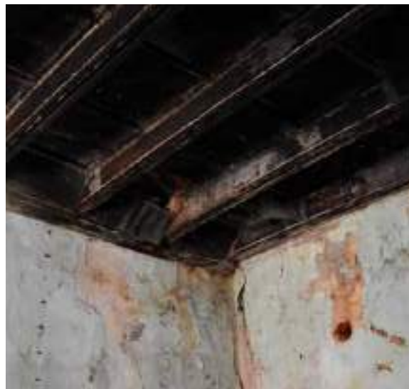
Castello di ponente, esfoliazione e perdita dello strato di finitura del solaio ligneo, Lagnasco, 2025.
