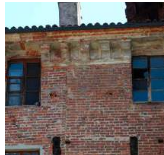
Castello di levante, fronte ovest, mancanza di pannelli vetrati negli infissi in legno, Lagnasco, 2025.
