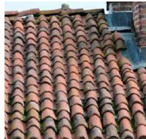
Castello di levante, distacco del manto di copertura in prossimità del colmo, Lagnasco, 2025.
