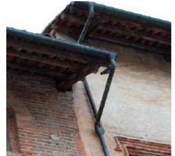
Castello di levante, fronte est, sistema di smaltimento delle acque piovane con gronde e pluviali verticali in rame , Lagnasco, 2025.
