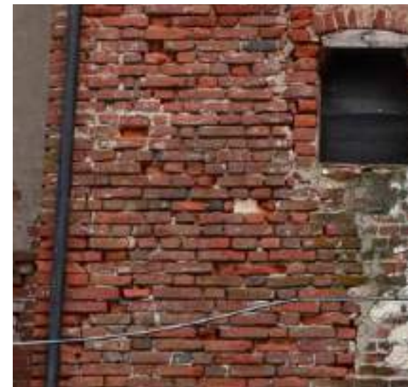
Castello di mezzo, corpo di collegamento alla torre scala, fenomeno di caduta dei giunti di malta , Lagnasco, 2025.
