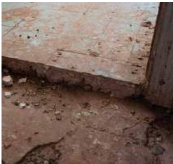
Castello di mezzo, fessurazioni e distaccamenti della pavimentazione, Lagnasco, 2025.
