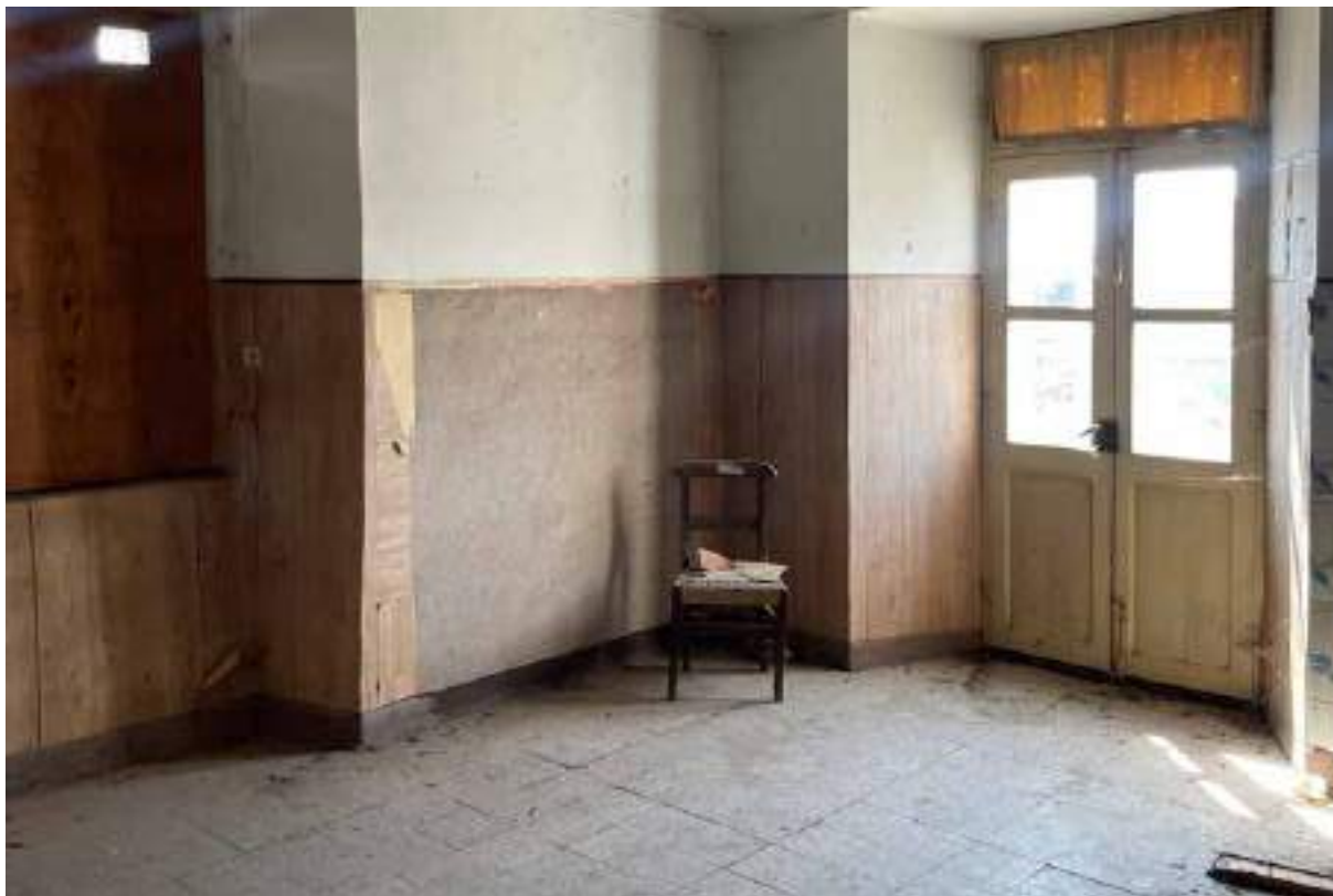
Fig. 59: Stanza con rilevanza storica in stato di abbandono nella manica est del castello di levante, Lagnasco, 2025.
