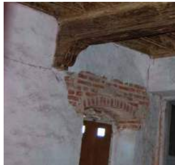
Castello di mezzo, distacco dell'intonaco ed esposizione della muratura , Lagnasco, 2025.
