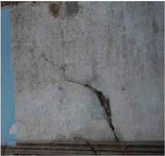
Castello di levante, fessurazione diagonale del rivestimento, Lagnasco, 2025.
