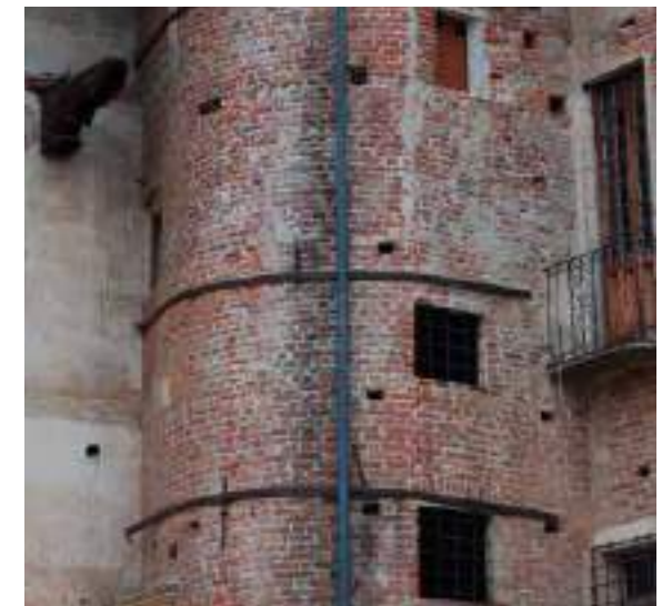
Castello di levante, torretta angolare sulla corte interna, fascia di colaticcio sulla cortina laterizia in prossimità del pluviale, Lagnasco, 2025.
