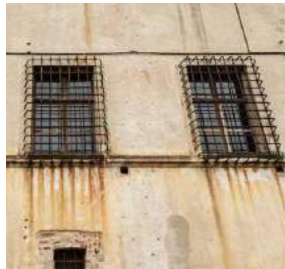
Castello di ponente, fronte ovest, colaticci sull'intonaco dovuti al trasporto di ruggine , Lagnasco, 2025.
