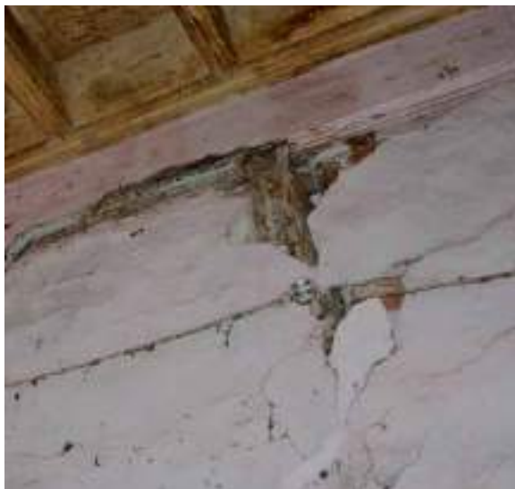
Castello di ponente, distacco dell'intonaco in corrispondenza della trave lignea , Lagnasco, 2025.
