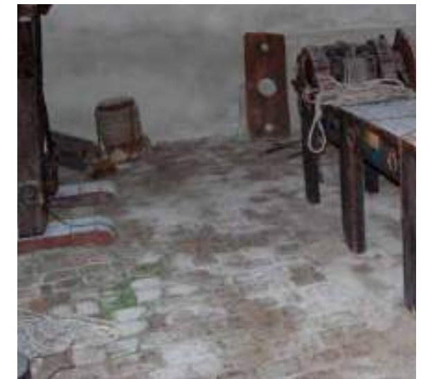
Castello di ponente, efflorescenze e patine biologiche nella pavimentazione degli ambienti del giro museale al seminterrato, Lagnasco, 2025.
