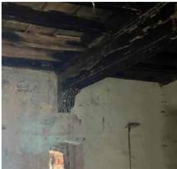
Castello di levante, esfoliazione e alterazioni cromatiche del solaio ligneo, Lagnasco, 2025.
