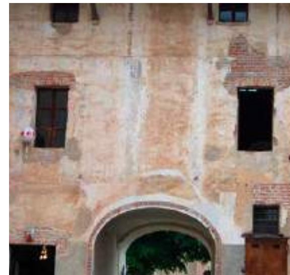
Castello di levante, fronte sulla corte interna, colaticcio su superficie intonacata con striature verticali e variazione cromatica, Lagnasco, 2025.
