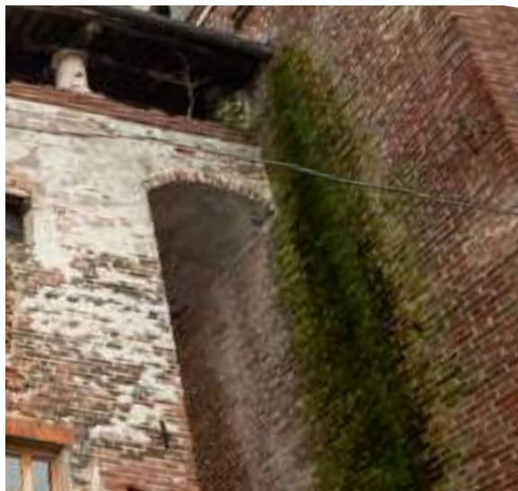
Castello di mezzo, corpo di collegamento alla torre scala, andamento verticale della patina biologica in prossimità della gronda, con elementi di vegetazione infestante, Lagnasco, 2025.
