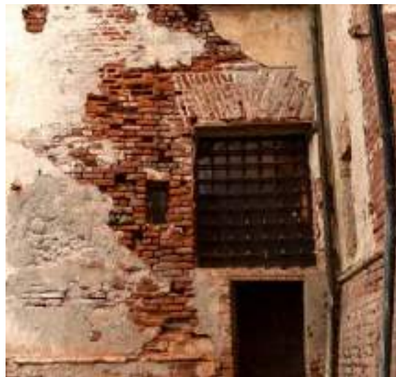
Castello di levante, angolo di giunzione con la torre nord-est, distacco dei laterizi sulla superficie intonacata , Lagnasco, 2025.
