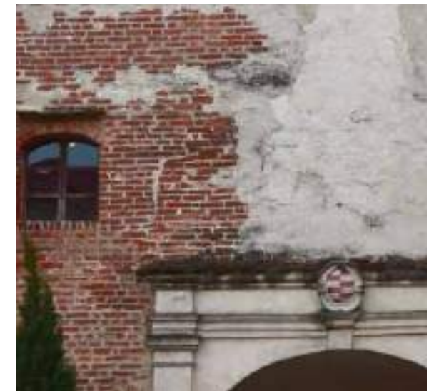
Castello di levante, accesso carraio principale sul fronte nord, caduta di porzioni di intonaco sopra al portale , Lagnasco, 2025.
