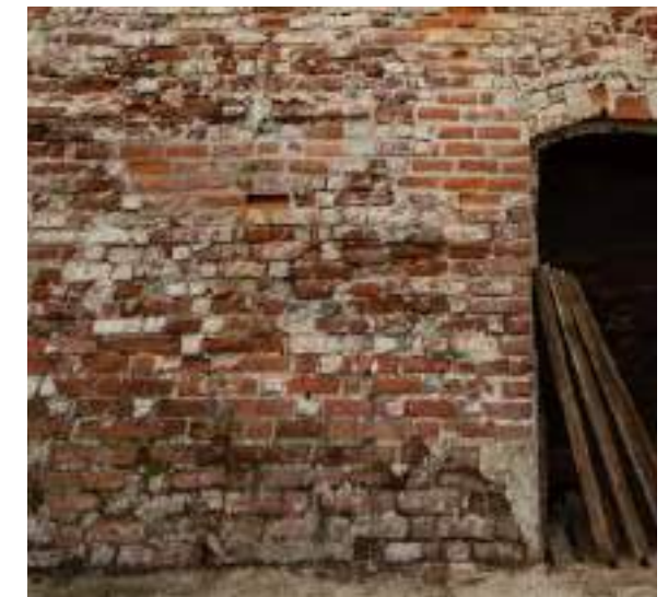
Castello di ponente, fronte ovest, erosione dello strato superficiale della muratura, Lagnasco, 2025.
