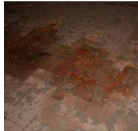
Castello di mezzo, alterazioni da umidità su pavimentazione in cotto, Lagnasco, 2025.
