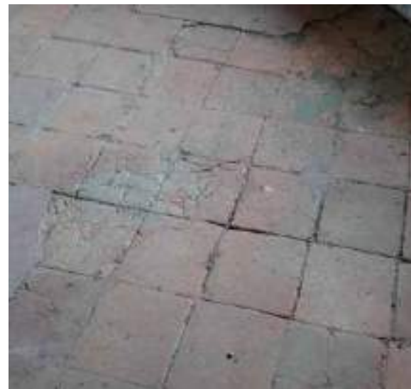
Castello di levante, fessurazioni e usura della pavimentazione del loggiato, Lagnasco, 2025.
