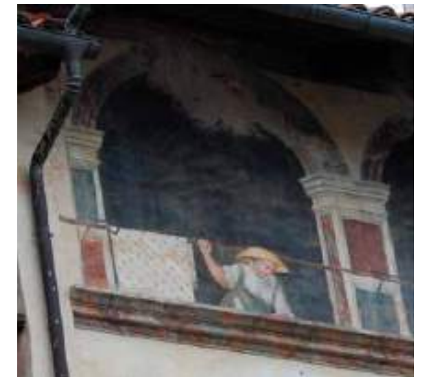
Castello di ponente, fronte est, pittura superficiale nel piano nobile, Lagnasco, 2025.
