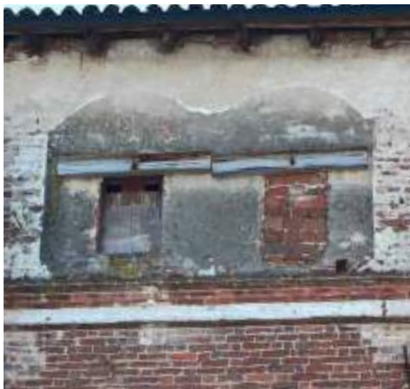
Castello di mezzo, ultimo piano della torre scala, antico loggiato tamponato con deposito superficiale e alterazione cromatica degli elementi pittorici, Lagnasco, 2025.
