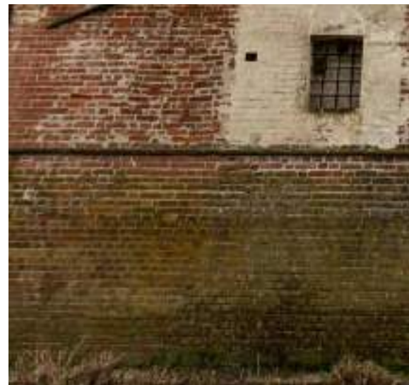
Castello di levante, torre sud-est, andamento orizzontale della patina biologica sulla fascia basamentale a contatto con il terreno, Lagnasco, 2025.
