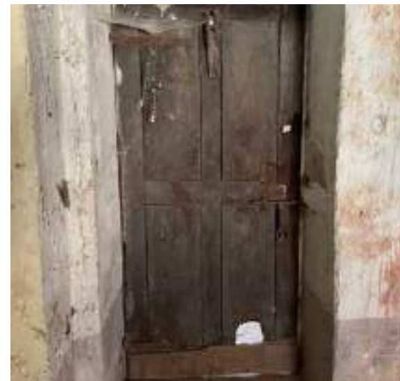
Castello di ponente, porta lignea a due ante con ferramenta ossidata e evidenti lacune e deformazioni , Lagnasco, 2025.
