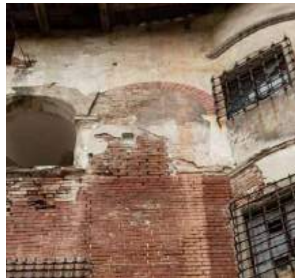
Castello di levante, fronte est, caduta e perdita di dipinti murali in prossimità del loggiato, Lagnasco, 2025
