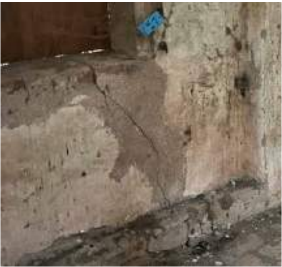
Castello di mezzo, fessurazione diagonale con segni di umidità, Lagnasco, 2025.
