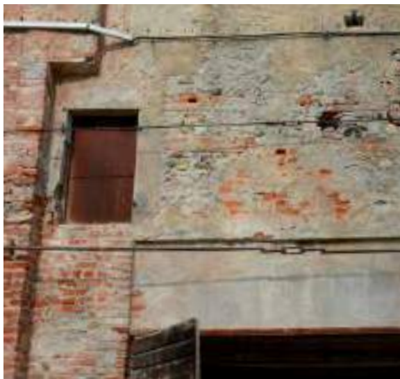
Castello di mezzo, fronte sud, perdita degli strati più superficiali e inscurimento della porzione di intonaco rimasta, Lagnasco, 2025.
