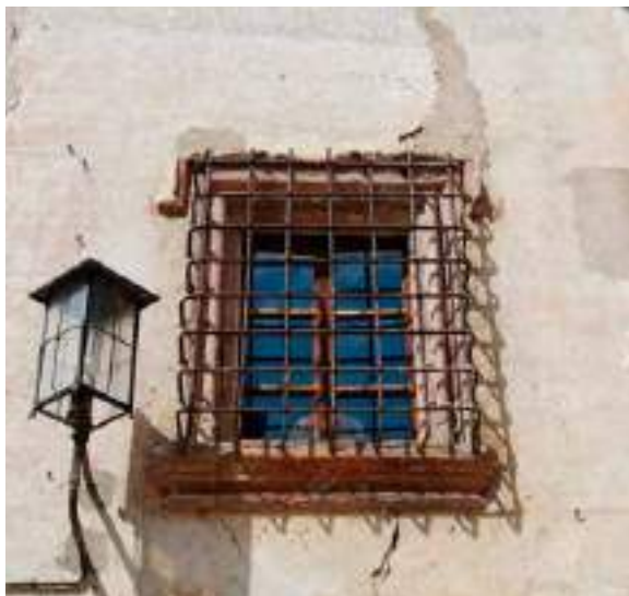
Castello di mezzo, fronte est, fenomeni di corrosione nelle grate protettive degli infissi, Lagnasco, 2025.
