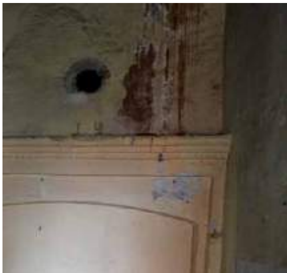
Castello di mezzo, aloni di umidità e colature verticali, Lagnasco, 2025.
