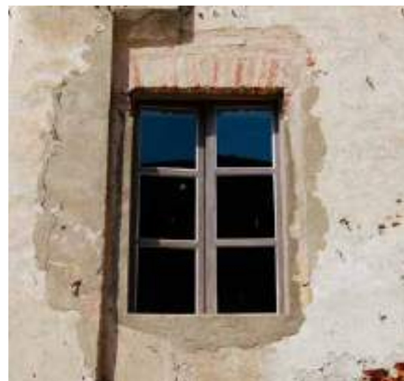
Castello di mezzo, fronte est, serramento in legno con vetro singolo e architrave in laterizio, Lagnasco, 2025.
