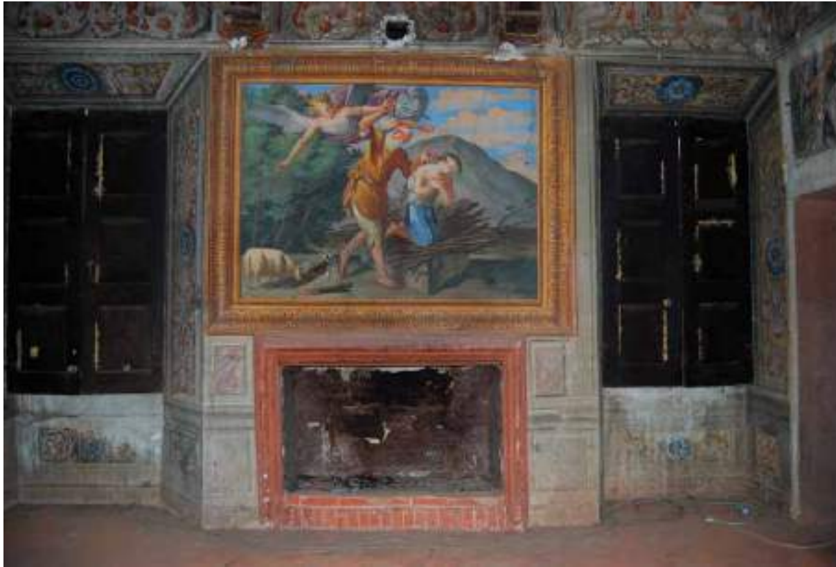
Fig. 58: Stanza con rilevanza storica in stato di abbandono nella manica est del castello di levante. Foto dell'autore, Lagnasco, 2025.
