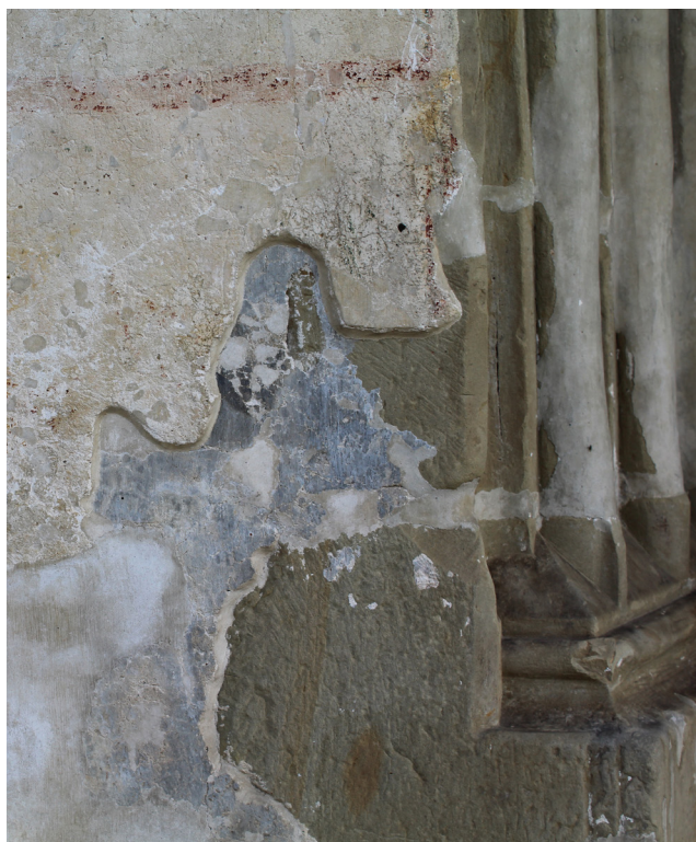
Figura 112 - Dettaglio del rivestimento esterno della chiesa sulla parete occidentale, presentando dei degradi. Fotografia scattata ad Ottobre 2025 dall'autore.
