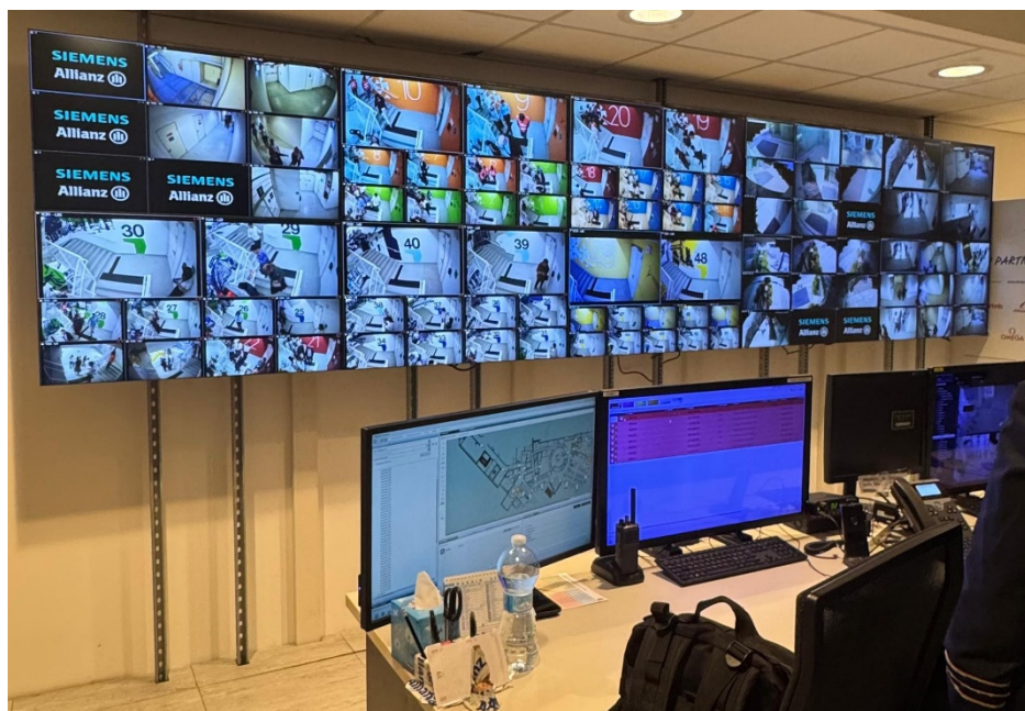
Figura 28. Control Room Torre Allianz; [foto di produzione propria]
