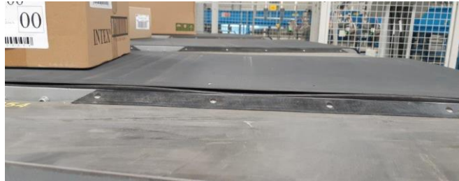
Figura 4.2.2 Vista A, deformazione del pianale di scorrimento della cella MBHS ® , in un impianto di prova, Leonardo S.p.A.
