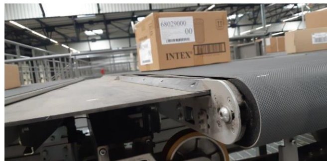
Figura 4.2.3 Vista B, deformazione del pianale di scorrimento della cella MBHS ® , in un impianto di prova, Leonardo S.p.A.
