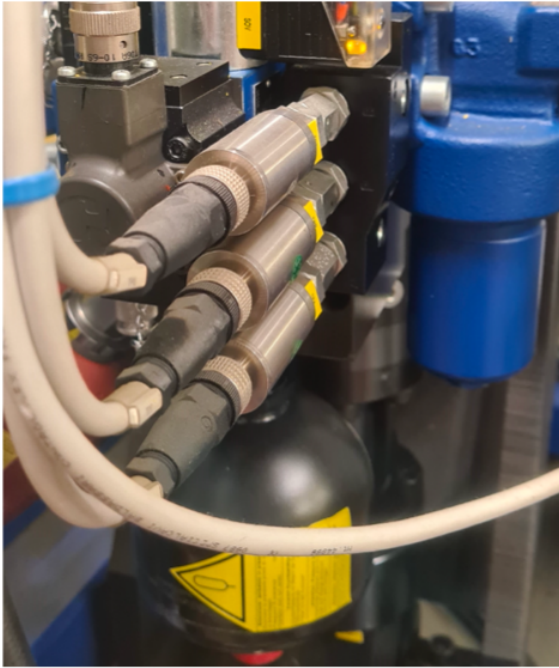
(a) Trasduttori di pressione Gefran TPSA installati sul blocco HLA.
