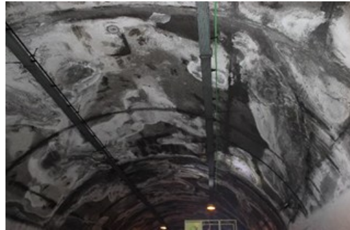
Figure 33 Frost (salt traces on surface) (Ministero delle Infrastrutture e della Mobilità Sostenibili, 2022)
