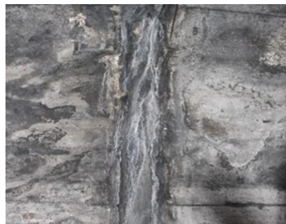
Figure 32 Stillicides (Ministero delle Infrastrutture e della Mobilità Sostenibili, 2022)
