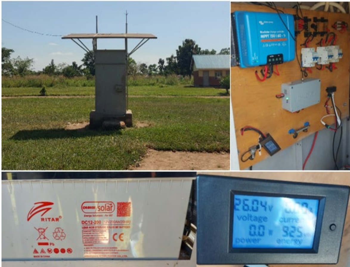
Figura 5.3 Impianto fotovoltaico progetto Hello World (2°50'34.8"N 32°12'58.5"E)
