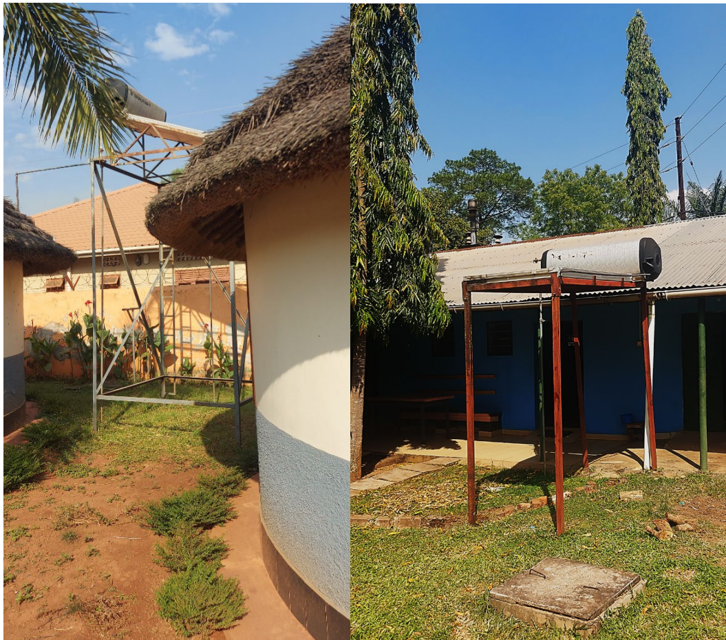
Figura 6.6 Fotografie collettori solari per riscaldamento acqua, Palm Garden Gulu
