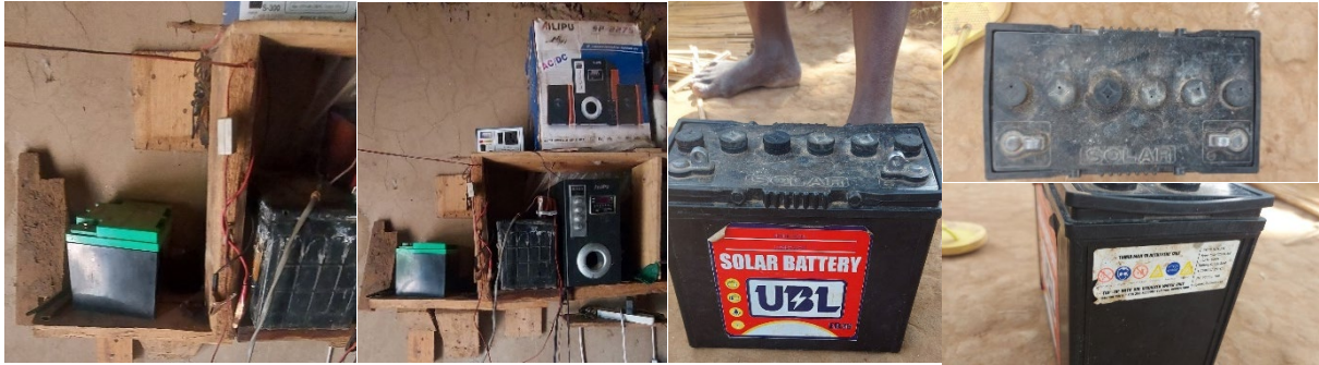
Figura 5.9 Batterie per sistemi solari domestici (ad acido liquido di recupero da macchina e apposite per pannelli solari)
