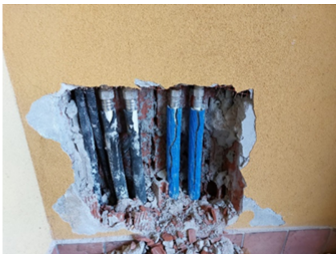
(a) Rottura tubo carico acqua
