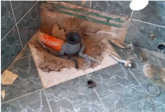
(a) Rottura tubo scarico wc
