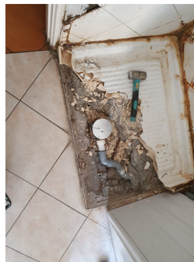
(b) Rottura tubo scarico doccia
