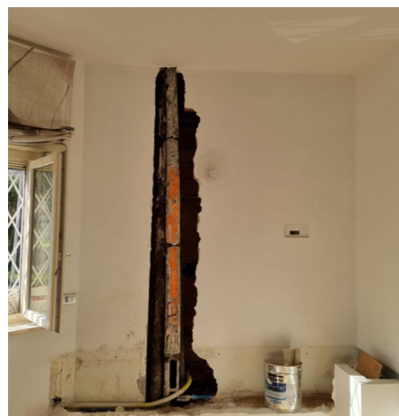
(b) Rottura colonna di scarico condominiale
