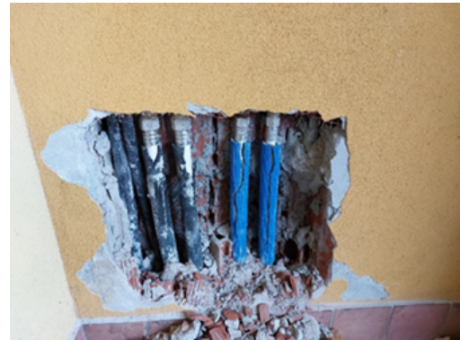
(b) Rottura tubo carico acqua
