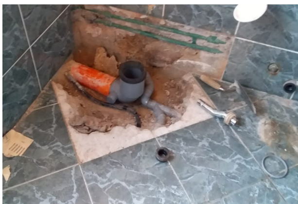
(a) Rottura tubo scarico wc
