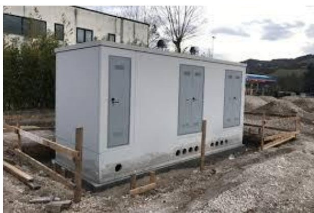
Figura 7 - Cabina elettrica di trasformazione in prefabbricato
