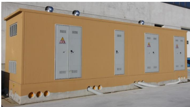
Figura 5 - Tipica cabina elettrica MT/BT prefabbricata
