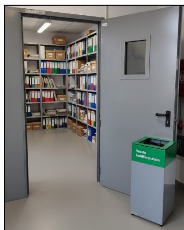
Figura 37: Esempio di mancata compartimentazione di un archivio realizzato tramite AI
