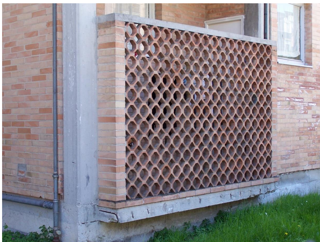
Figura 5.5: Crepe e ferri d'armatura scoperti – Foto personale scattata Agosto 2023.
