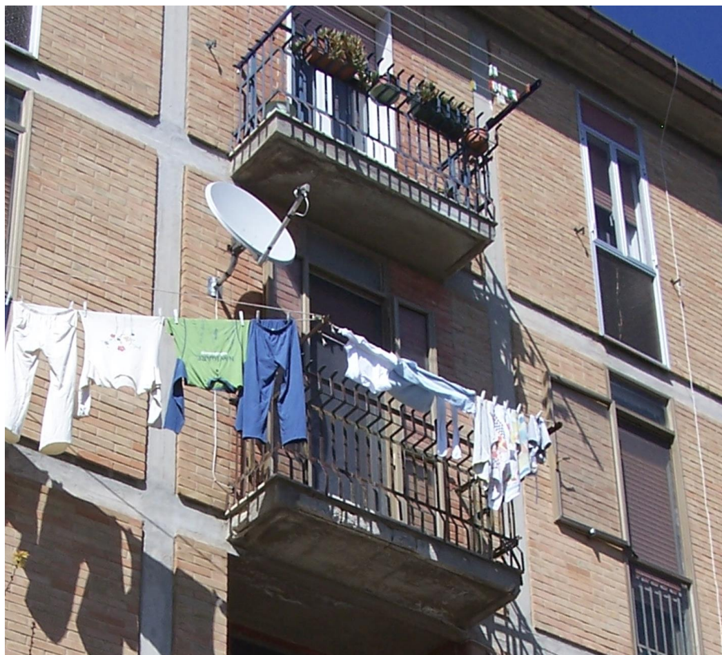
Figura 5.4: Crepe e ferri d'armatura scoperti – Foto personale scattata Agosto 2023.
