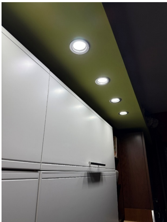
Figura 6: Faretto incassati nel controsoffitto, Fotografia di produzione propria
