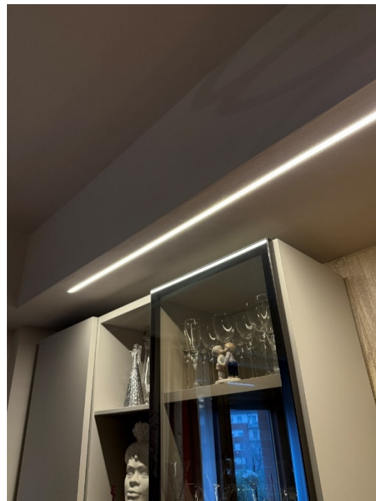
Figura 7: LED incassati nel controsoffitto, Fotografia di produzione propria
