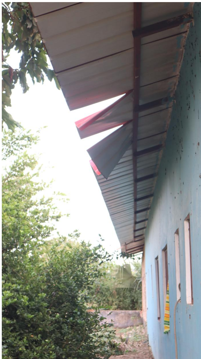
Fig. 5.21 – Dormitorio. Lato Nord con evidenza della lamiera divelta (fotografia dell'autore).
