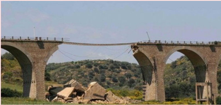
Figura 2.36 Crollo del Ponte lungo la tratta Caltagirone-Gela, 2011. Fonte: La Repubblica Palermo
