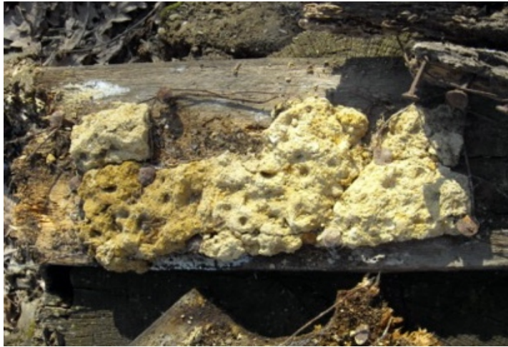
Fig. 96. Resti del capanno del Meleto, asse di legno della facciata intonacata, documentazione fotografica Archivio Ufficio Tecnico Comune di Agliè.
