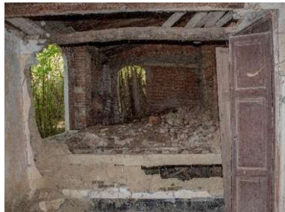
Figura 37: Stato di degrado interno di Cascina Sbriggia
