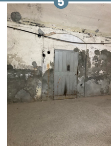
Degrado superficiale e umidità di risalita.
