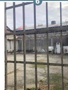
Verde infestante e degrado superficiale.
