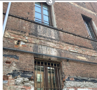
Degrado superficiale e mancanze.
