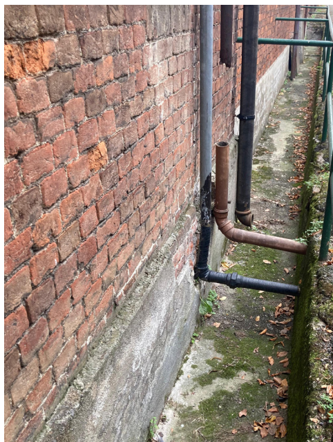
Fig. 47_ Carceri Le Nuove, Torino, arretramento del terreno (Fotografia d'aut., 2025)
