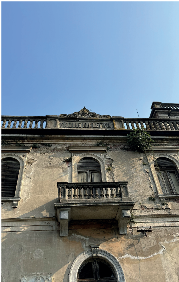
30 | Prospetto sud, degradi Foto dell'autrice
