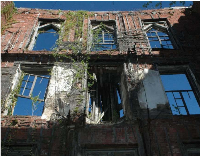
Figura 2.37. Deformazione del muro occidentale dello Smallpox visto dall'interno. [John Milner Associates, Smallpox Hospital Ruins. Phase 1A Emergency Stabilization Completion Report , 2009]
