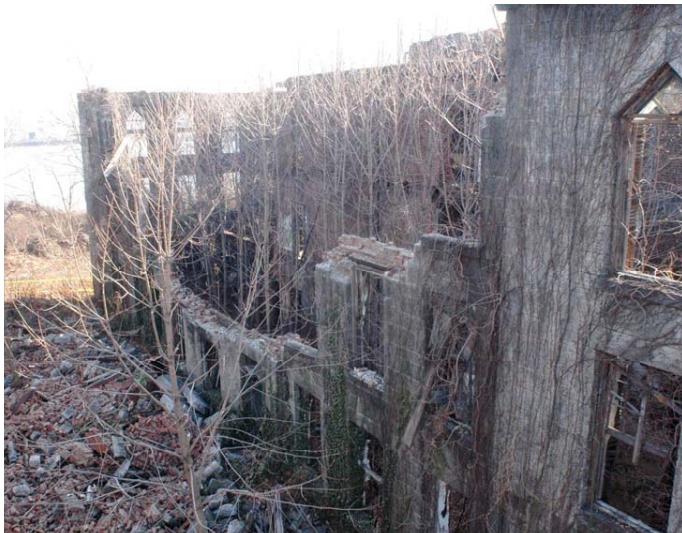
Figura 2.38. La manica settentrionale dello Smallpox interessata dal crollo avvenuto nel 2007. [John Milner Associates, Smallpox Hospital Ruins. Phase 1A Emergency Stabilization Completion Report , 2009]
