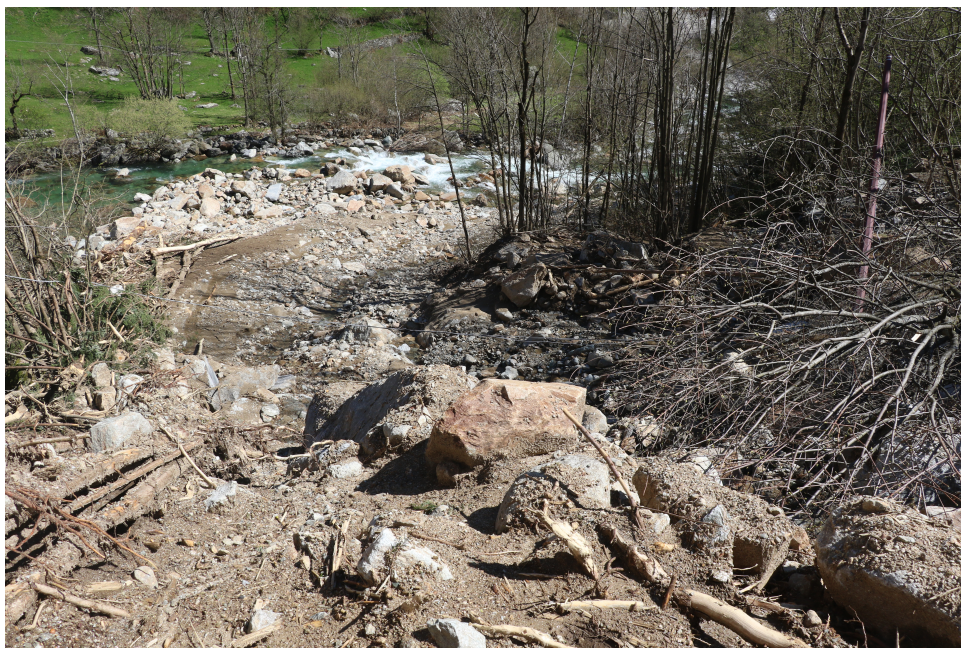
Figura 65: Strada comunale verso Fondo dopo l'evento 15-17 aprile
