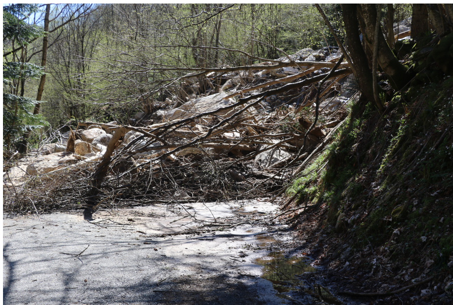
Figura 71: Vista laterale della strada da cui si evince l'integrità della sede stradale, segno di una colata con molto fine in sospensione e dilavato, nonché l'abbondante presenza di materiale vegetale (tronchi e ramaglie) tra il pietrame e il ciottolame segregato e ivi depositato
