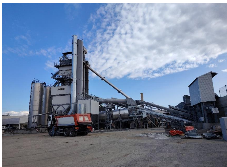
Figura 43. Miscelatore in impianto
