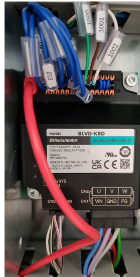
Figura 7.19: Modulo driver brushless installato nel quadro elettrico
