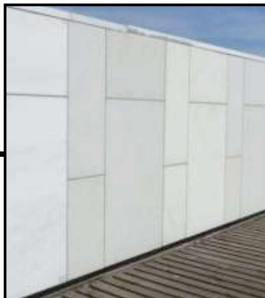
Lastre difettose dopo la sostituzione
