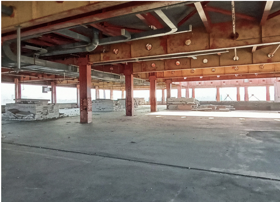
↑ Vecchi impianti a vista. Fotografia del terzo piano
