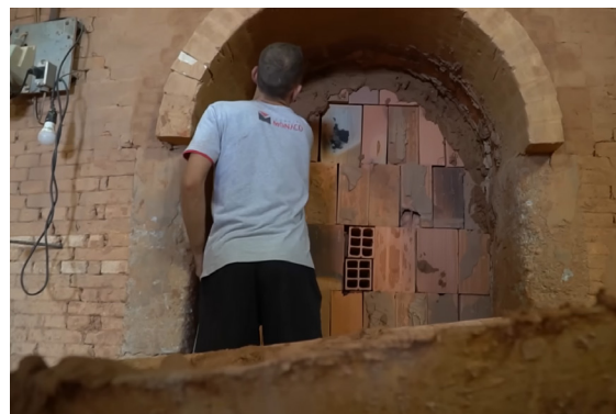
(Fig. 84) Sigillo manuale del forno con argilla fresca per garantire il raggiungimento della temperatura interna richiesta.
