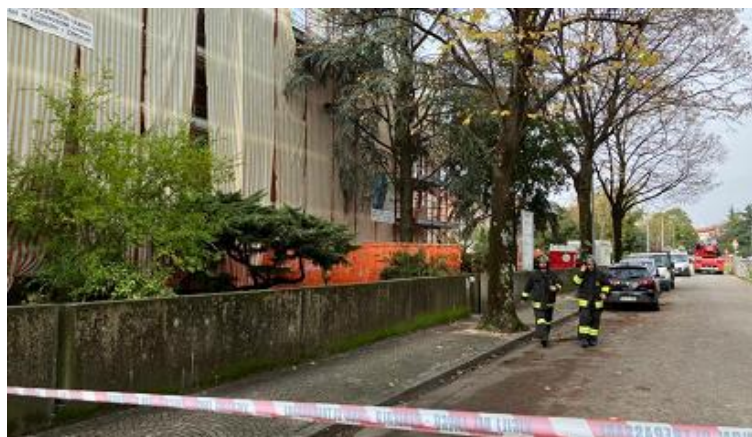
Figura 54. Cantiere dove è avvenuta l'esplosione [70]
