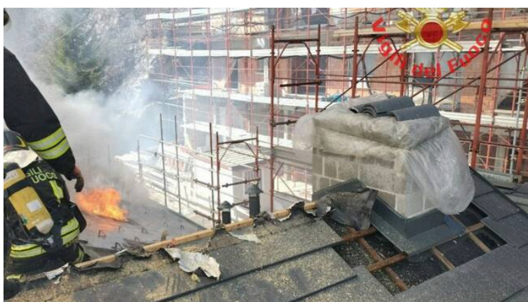
Figura 38. Dettaglio incendio copertura [39]
