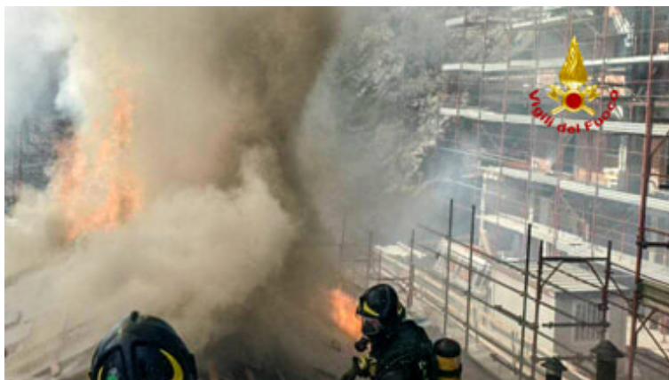
Figura 37. Dettaglio incendio copertura [39]
