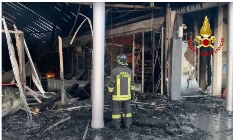
Figura 44. Situazione post incendio, estratto da video [50]
