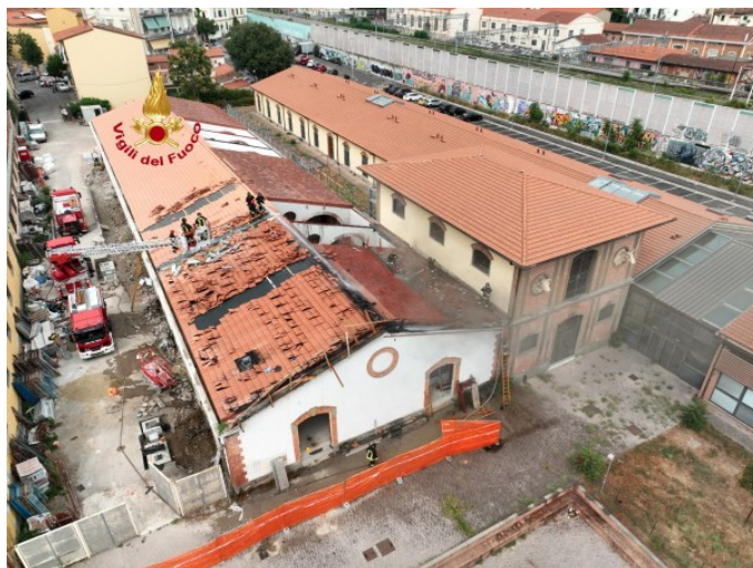
Figura 58. Fabbricato in ristrutturazione in cui è avvenuto l'incendio [78]
