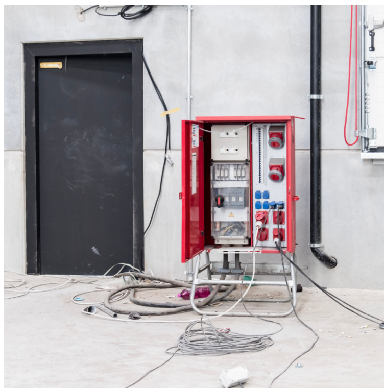
Figura 120. Quadro elettrico di cantiere [112]
