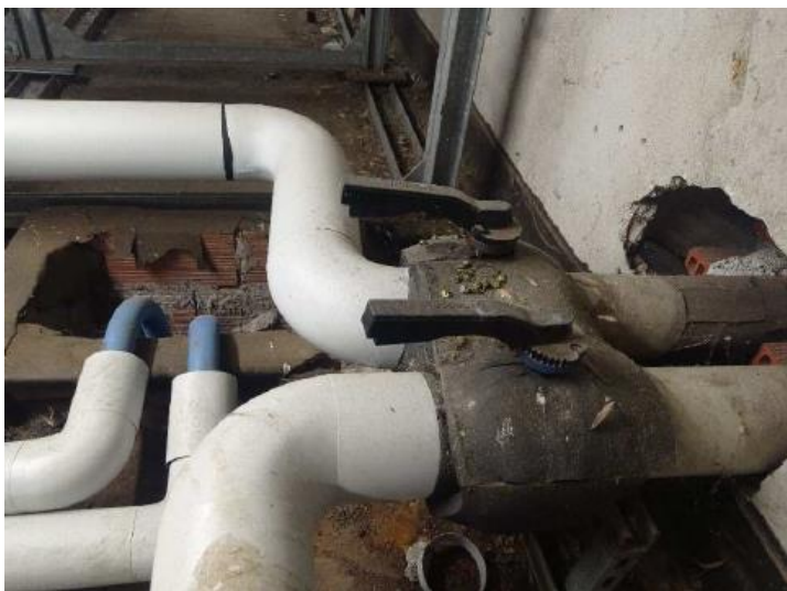
Figura 38 – Dettaglio degli stacchi della rete di distribuzione nel sottotetto [5]
