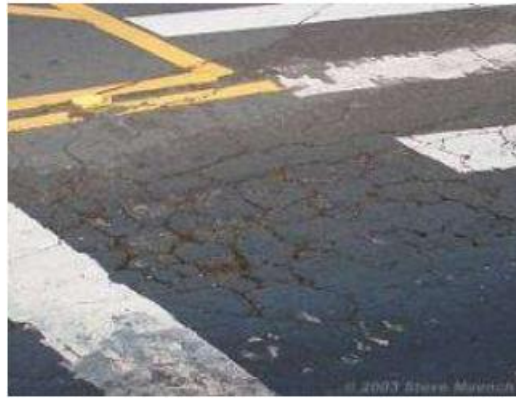
Figura 5 – Fessurazione a ragnatela
