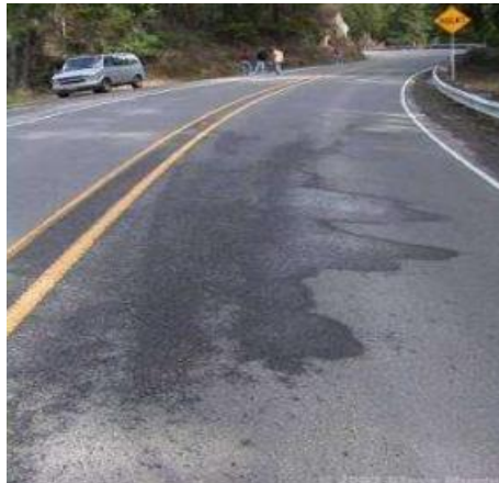
Figura 29 – Essudazione di acqua
