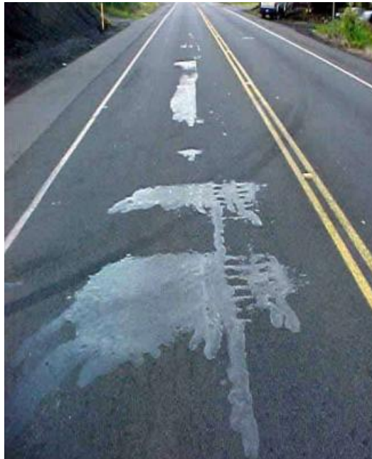
Figura 24 – Essudazione di bitume
