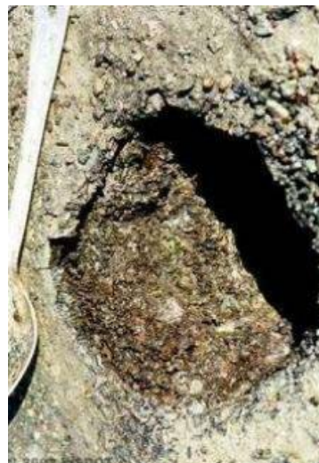
Figura 27 – Scagliatura della superficie
