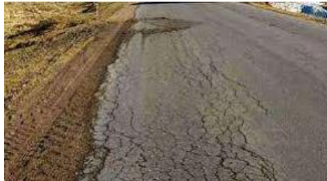
Figura 9 – Fessurazione di bordo
