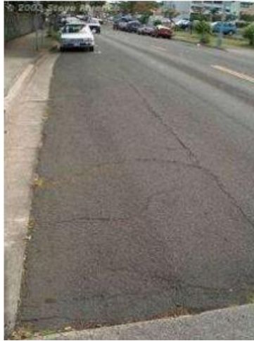
Figura 8 – Fessurazione a blocchi
