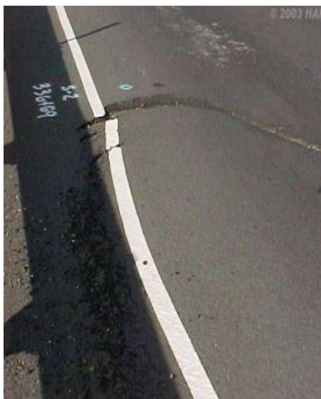
Figura 13 – Fessurazione da scorrimento
