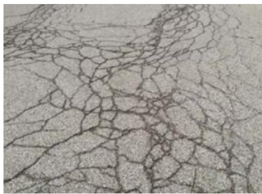
Figura 6 - Fessurazione a ragnatela
