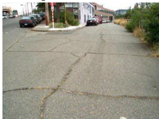
Figura 12 – Fessurazione di richiamo
