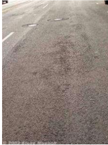
Figura 26 – Scagliatura della superficie
