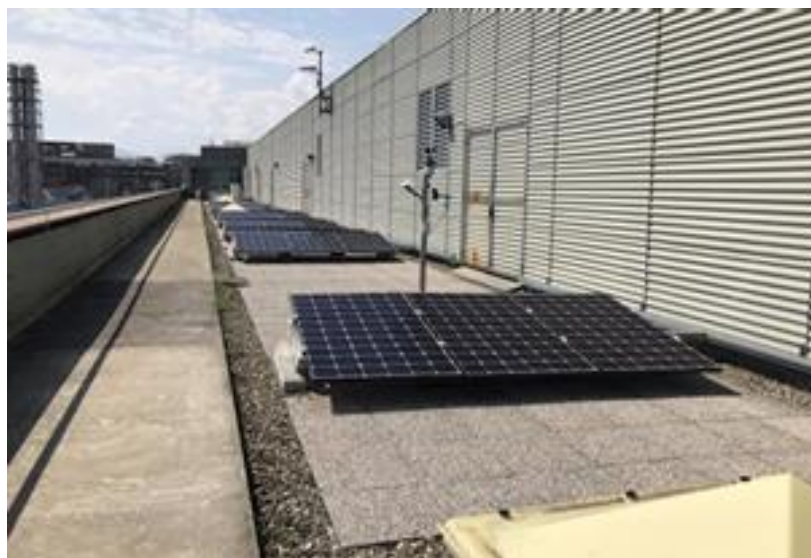
Figura 4-4: Zona esterna del laboratorio PVZEN [1]
