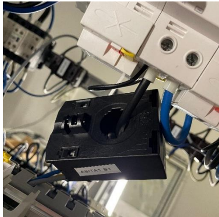
Figura 5-24: TA ASITA TD5 installati nel quadro di laboratorio
