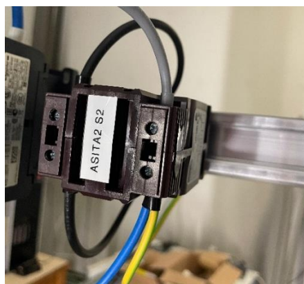
Figura 5-25: TA IME TAQ2-M installati nel quadro di laboratorio
