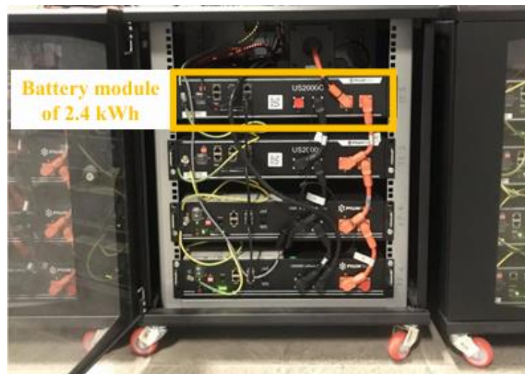
Figura 4-7: Armadio contenente i 4 moduli Pylontech connessi in parallelo
