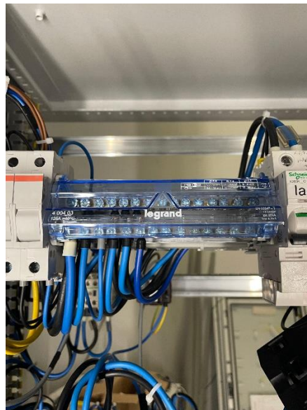
Figura 5-28: Morsettiera Legrand installata al laboratorio
