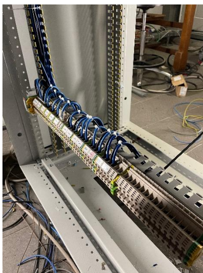
Figura 5-30: Morsettiera di quadro del Quadro Principale
