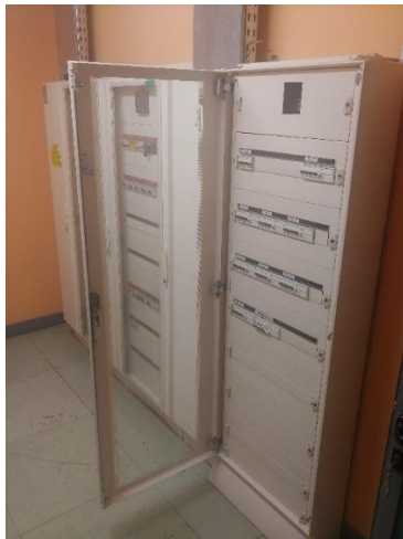
Figura 4-16: Quadro di zona QUFF10
