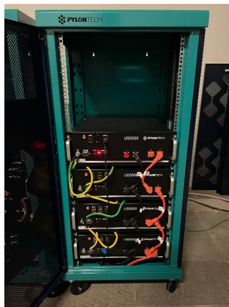
Figura 5-4: Armadio contenente 4 moduli Pylontech US5000C
