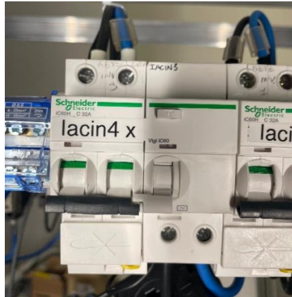
Figura 5-38: Foto di un interruttore utilizzato provvisoriamente e contraddistinto dalla lettera “X”
