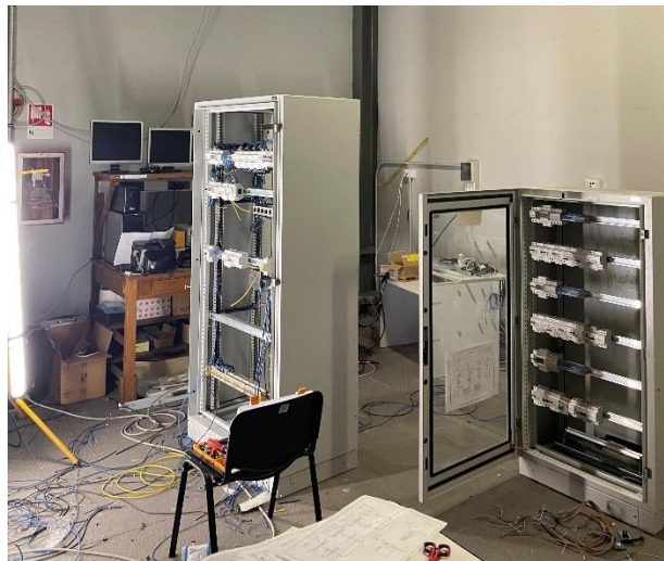
Figura 5-23: Foto dei quadri elettrici nelle prime fasi di cablaggio. Sul retro il banco sul quale sono posizionati computers, monitors e server
