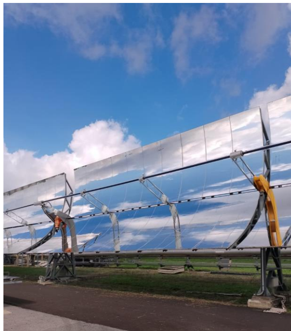
Figure 6 - Parabolic trough collector in Centro Ricerche Casaccia (ENEA)
