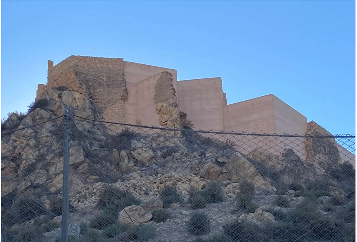
Figura 2.99. Intervento sul prospetto Est della Muralla del Castillo de Lorca, 2023. Immagine dell'autore. La consistente porzione di muratura distrutta è stata reintegrata con un nuovo muro in calcestruzzo armato di colorazione rosea. L'immagine rimarca la volontà del progettista di distinguere l'intervento dalla preesistenza.
