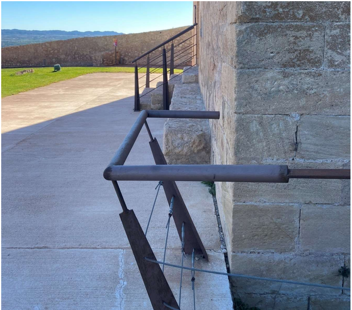
Figura 2.92. Torre del Espolon, Lorca. Dettaglio dei corrimano, 2023. Immagine dell'autore.
