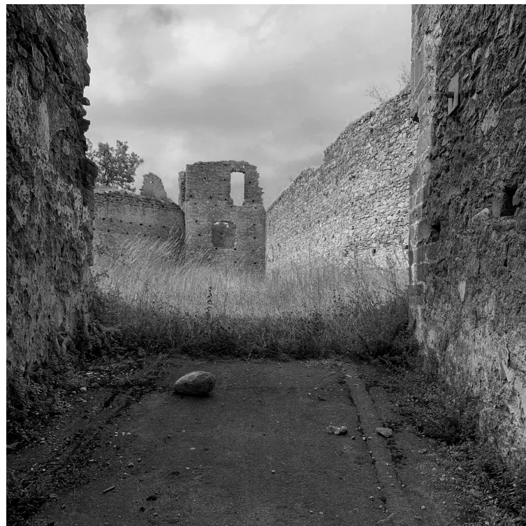
(19) Stato di abbandono del castello di Roccavignale ( Sopralluogo Agosto 2021 )
