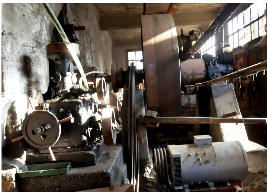
Figura 4.2.3- Fotografia della Centralina elettrica del mulino Monterosso Grana.
