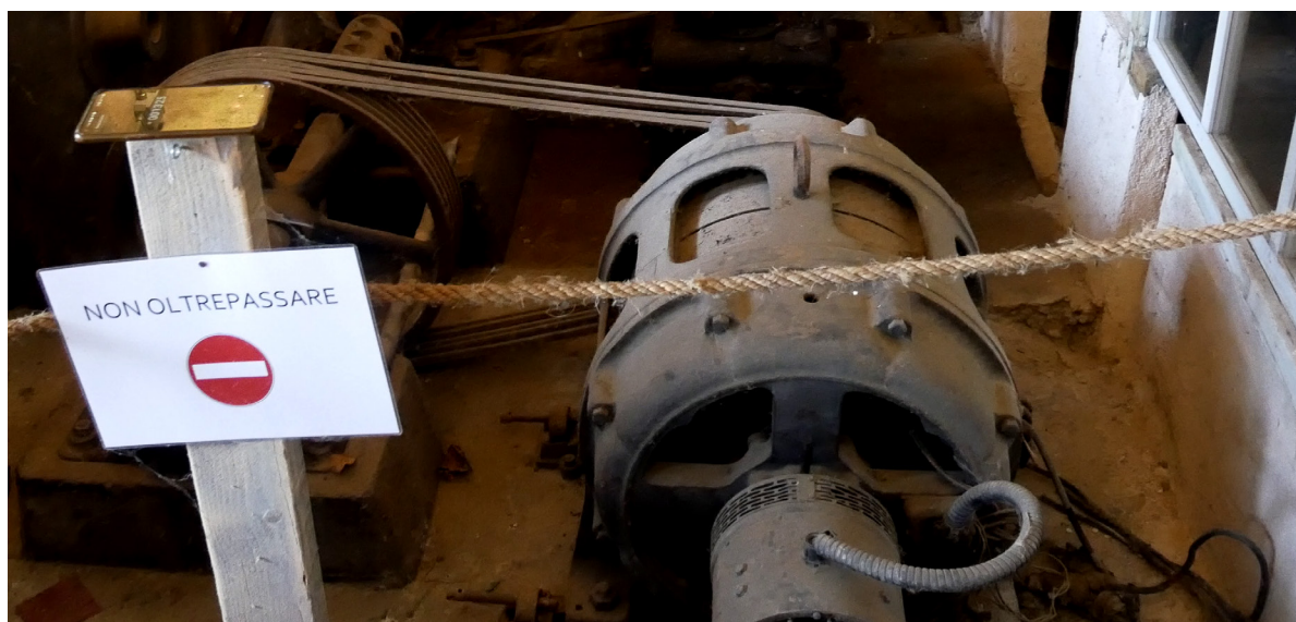
Figura 4.4.3- Fotografia della centralina elettrica del mulino di Pradleves
