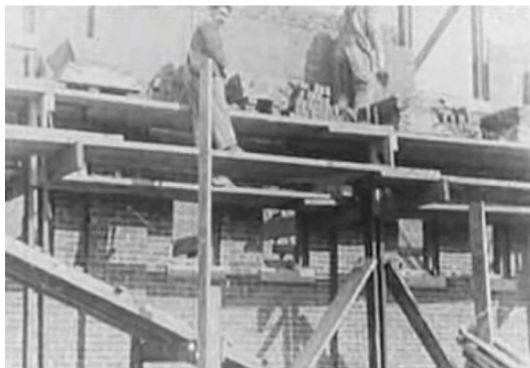
Figura 12: Mantenendo l'area di presa a livello del muro, si evita di dover sollevare i mattoni da terra, o da altezze scomode, rendendo il lavoro più agevole ed accessibile [38].
