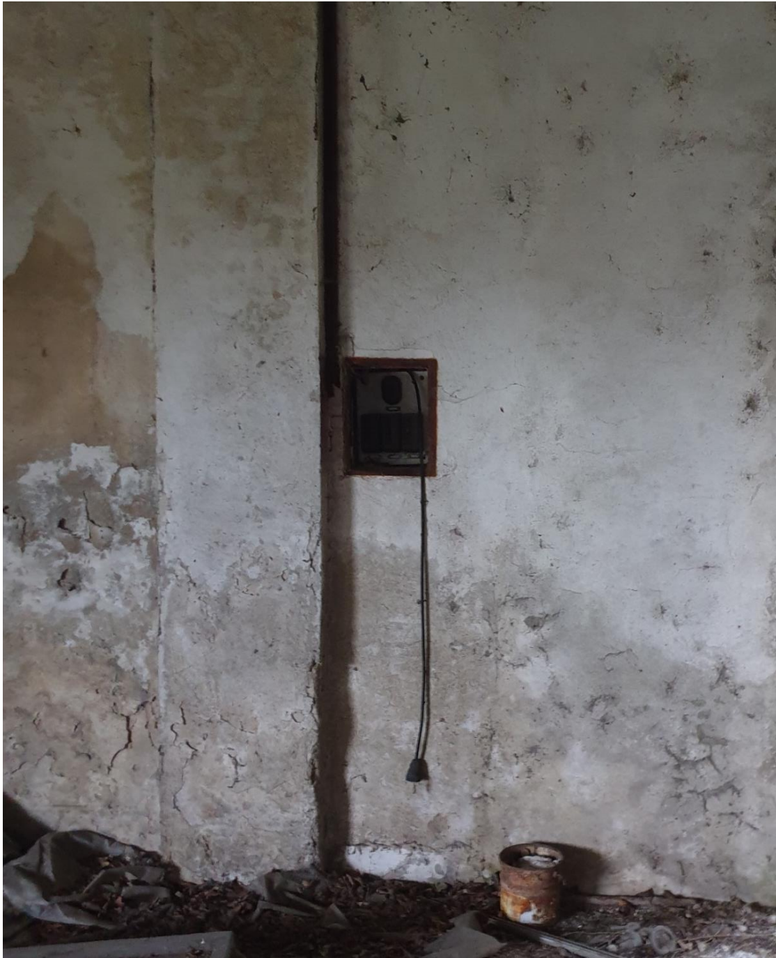
Fotografia 10, Particolare interno dell'edificio deposito corto. Lo strato di intonaco risulta fortemente danneggiato da diverse tipologie di degrado.
