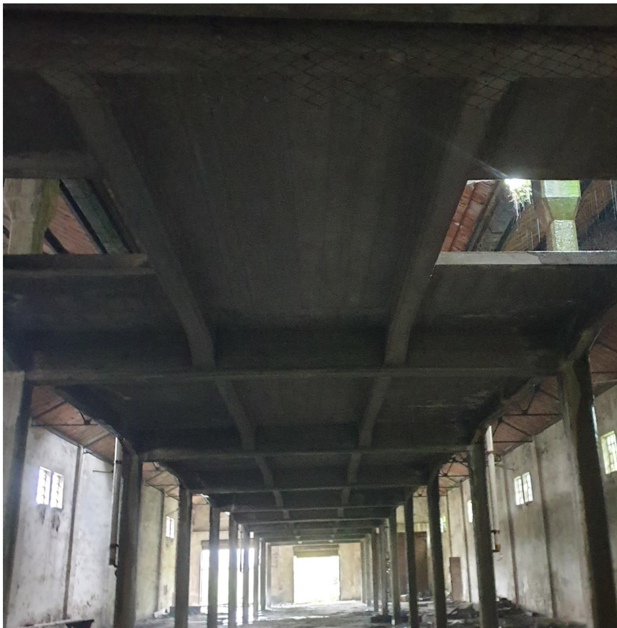
Fotografia 6, particolare strutturale del piano di caricamento della campata centrale dell'edificio deposito corto, realizzata interamente in cemento armato. L'altezza libera fra i due piani di calpestio è pari a 4 metri.
