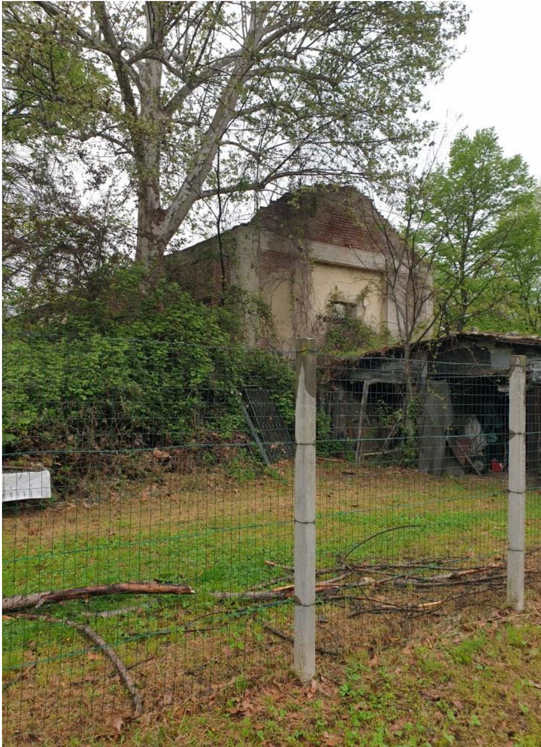
Fotografia 14, Timpano in mattoni sul fronte sud dell'edificio tettoia. Attualmente risulta impossibile avvicinarsi ulteriormente alla facciata principale a causa della vegetazione.
