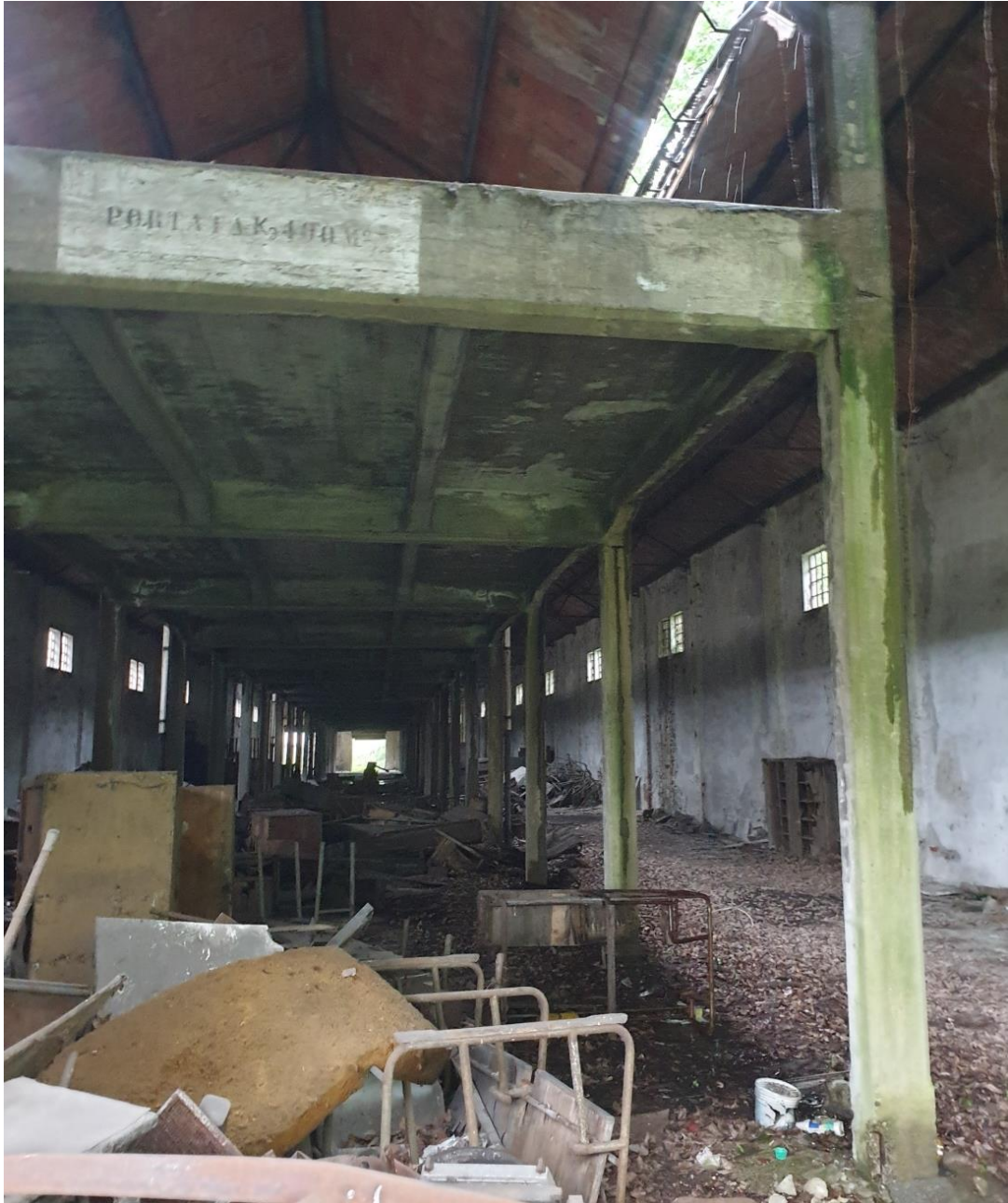
Fotografia 8, particolare interno della prima campata dell'edificio deposito corto. L'edificio presenta un'elevata quantità di detriti e rifiuti generici.
