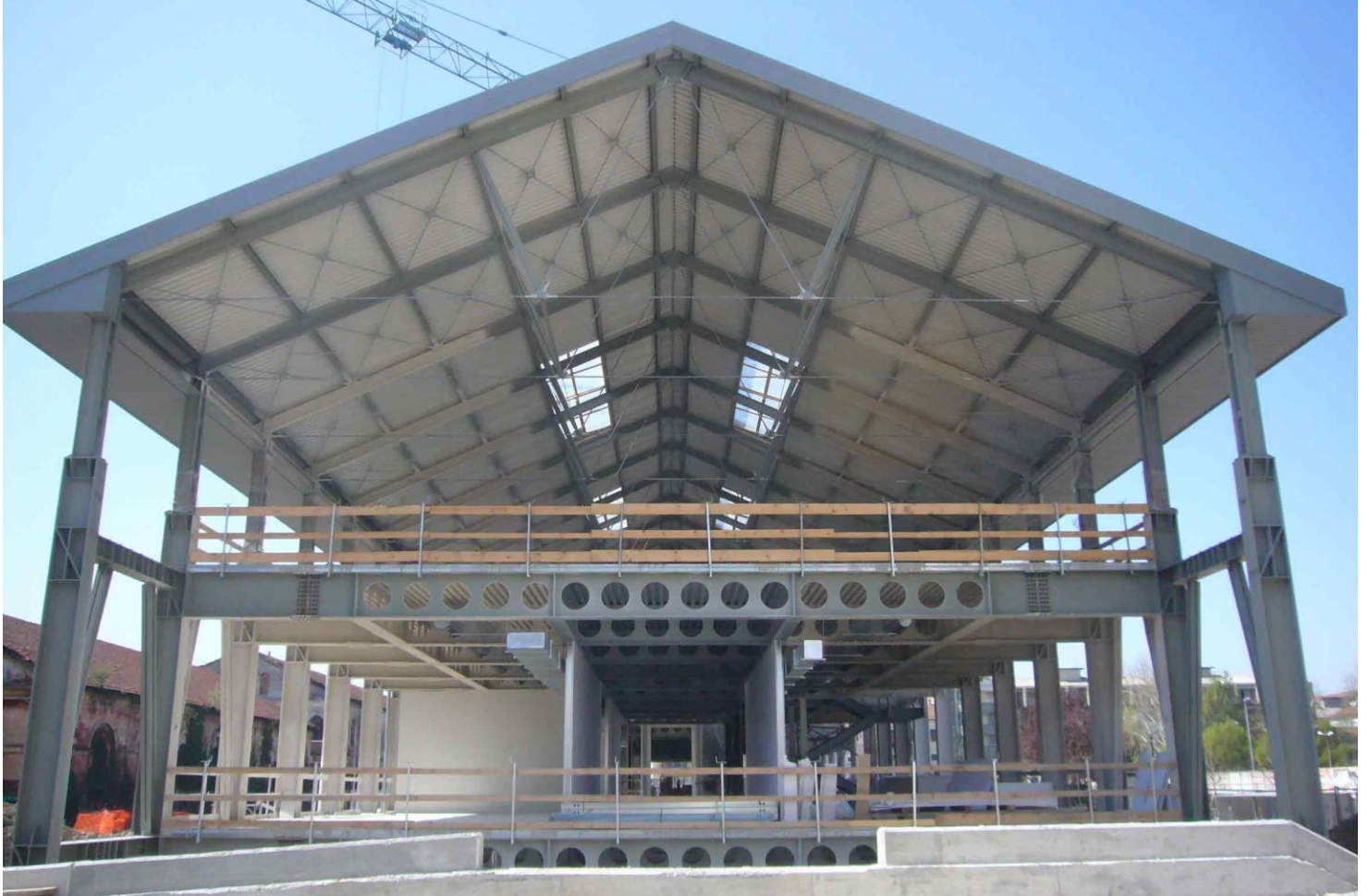
Fig.5) Riferimento progettuale per la copertura a capriate e la struttura interna. Ex caserma Perrone, Novara, progetto L.Rossi Associati. Fotografia dal sito: "The Plan"
