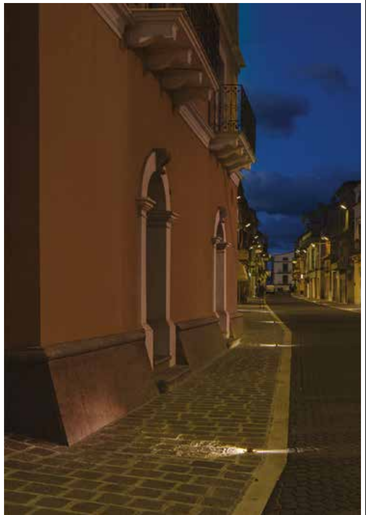
Foto di dettaglio degli apparecchi ad incasso nel pavimento
