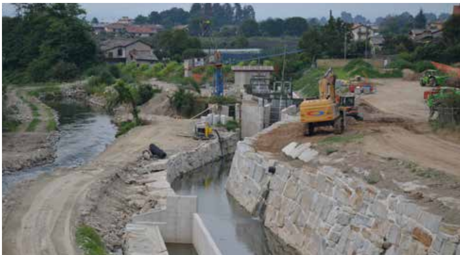
Fig.06. Vasca di ripartizione del Torrente Pellice (2024)
