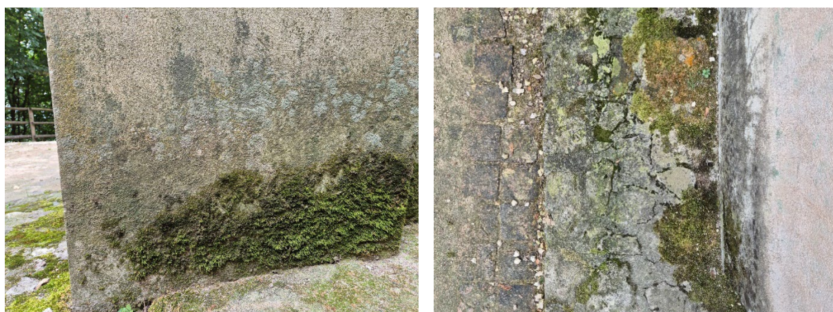
Figura 49: Patina biologica alla base del muro destro (sinistra) e sul camminamento esterno (destra).
