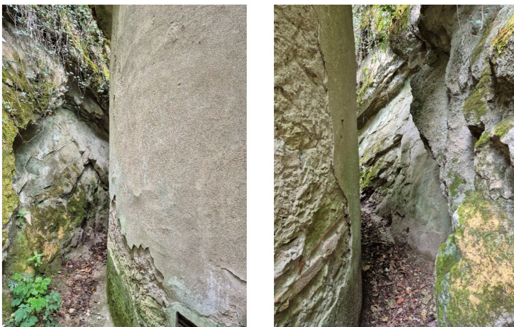
Figura 52: Degrado retro del manufatto a sinistra (sinistra) e destra (destra).
