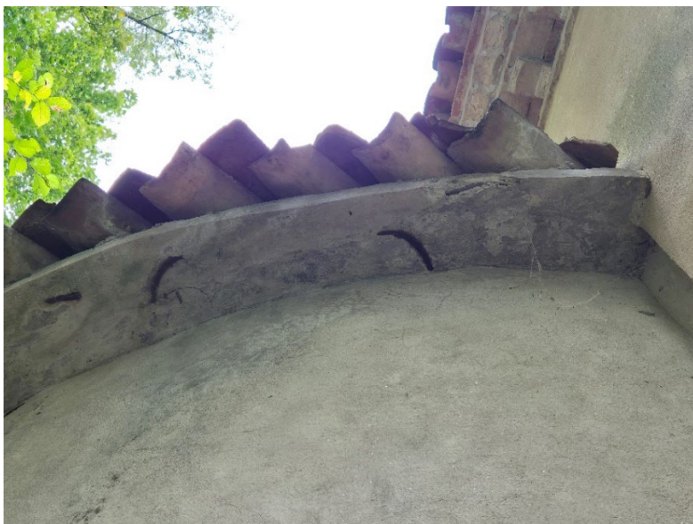
Figura 54: Degrado copertura abside.
