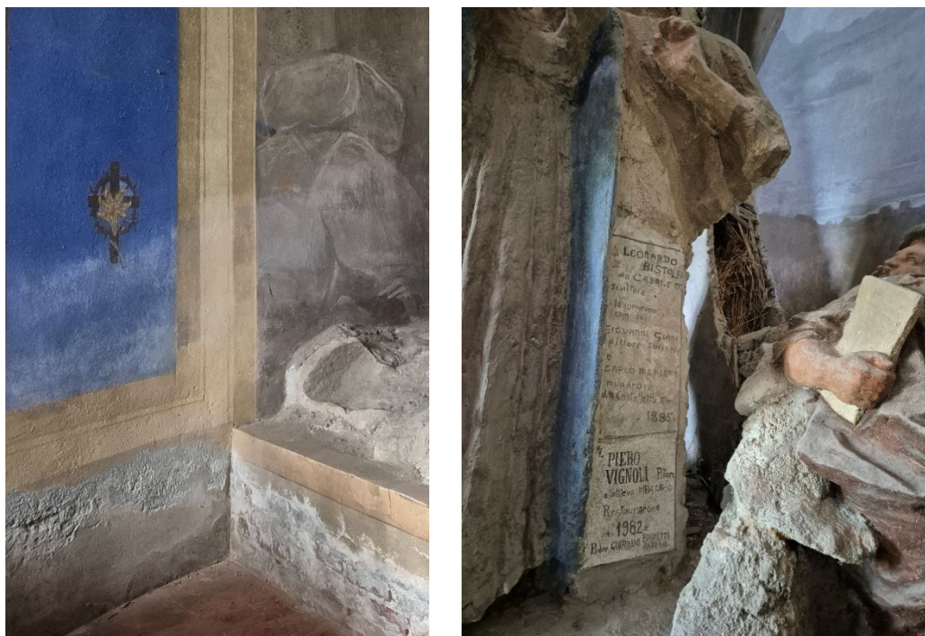
Figura 63: Dettaglio degrado interno.
