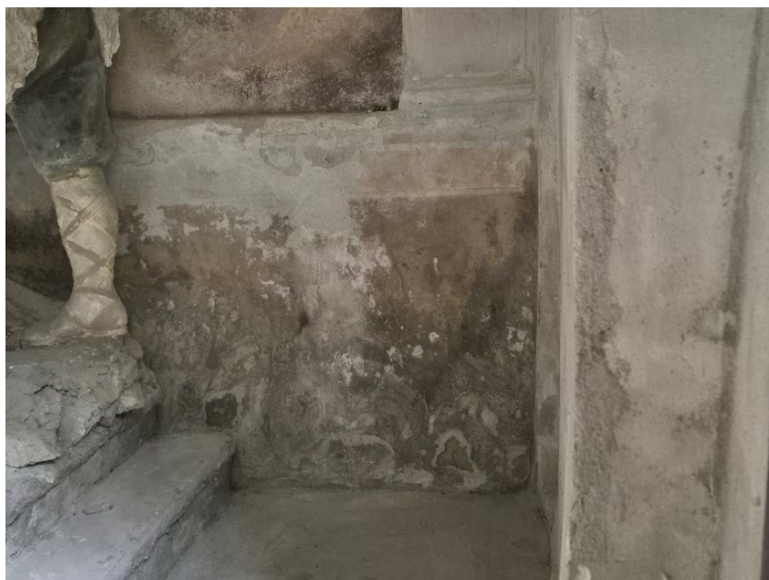
Figura 50: Fronte di risalita interno con incrostazione salina.
