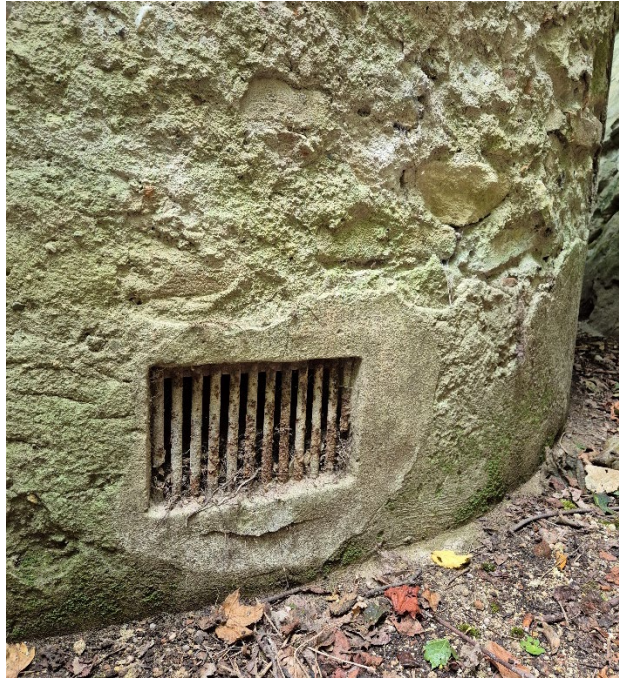
Figura 53: Degrado apertura ventilazione.
