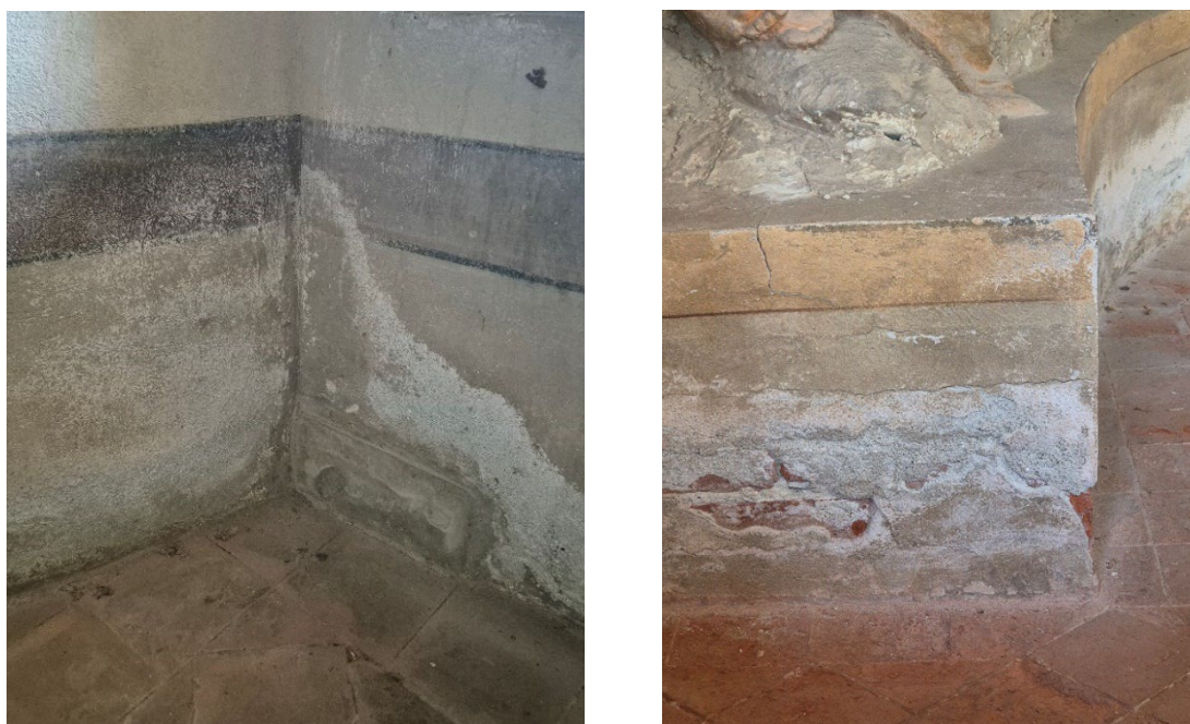
Figura 60: Degrado interno dato da efflorescenze saline (sinistra) e distacco della malta (destra).
