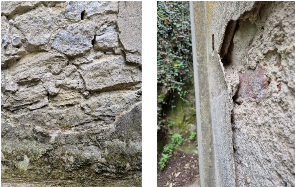
Figura 51: Distacco intonaco muro esterno (sinistra) e dettaglio (destra).
