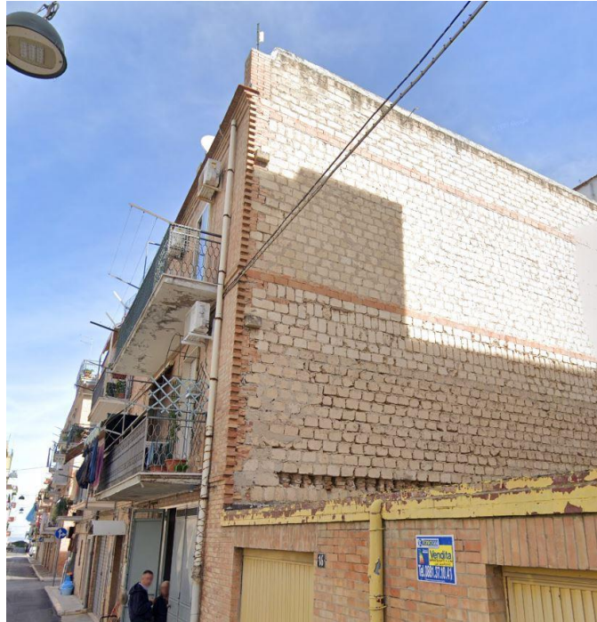
Figura 74 Assenza di murature a sacco nella tipologia MUR1 del comparto C02
