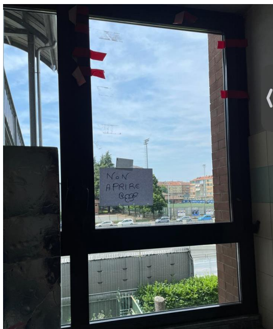
Figura 5 - Esempio di danno in cui è intervenuto il vetraio in appalto
