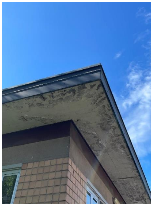
Figura 3 - Questo elemento di muratura, danneggiato a causa delle infiltrazioni rientra tra i danni della categoria edile
