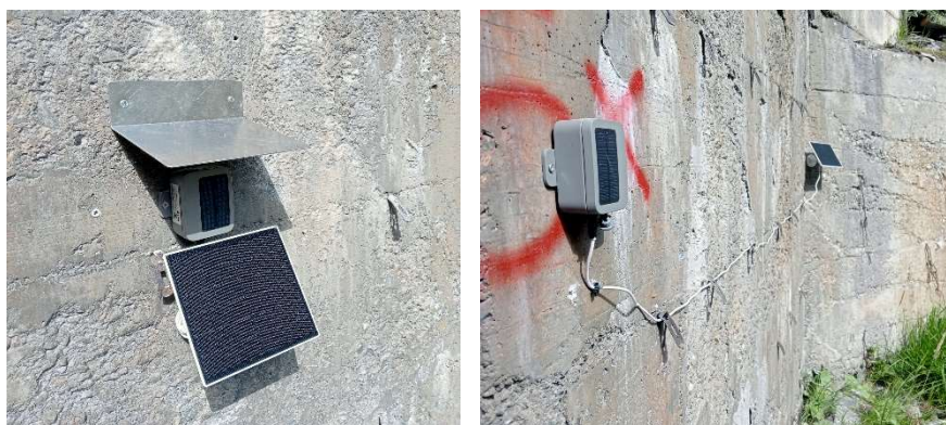
Figura 5.17: Accelerometro ACM2 e sismometro EQ2 successivamente all'installazione dei pannelli solari aggiuntivi e della tettoia
