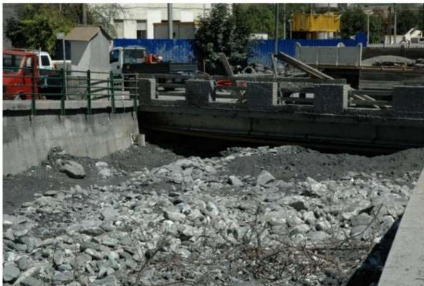
Figura 3.12: Ostruzione della luce del ponte di Via Europa da parte dei depositi di colata
