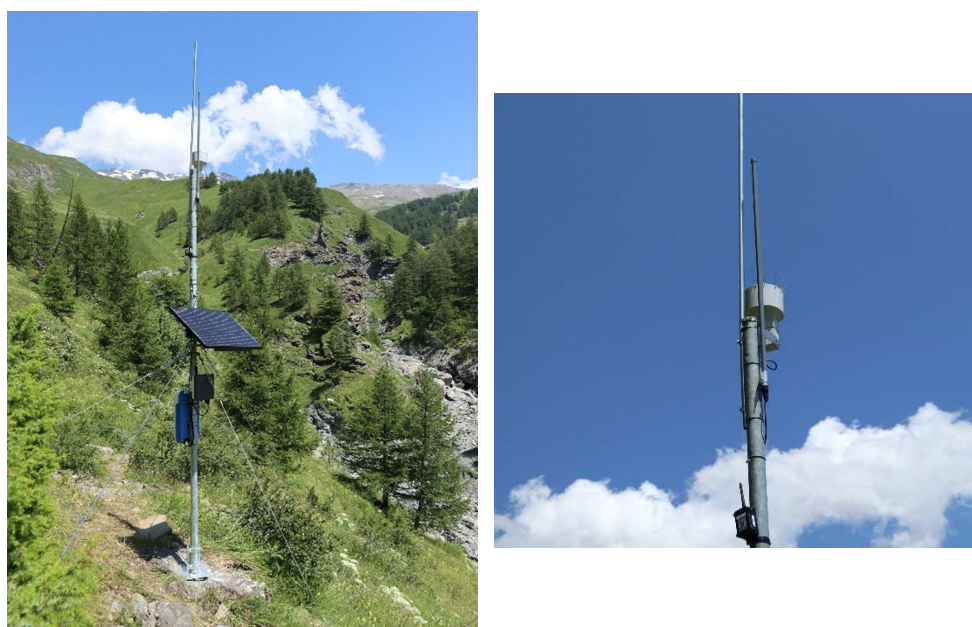
Figura 5.13: Gateway GWT1 in località Camini, con dettaglio del pluviometro RM1
