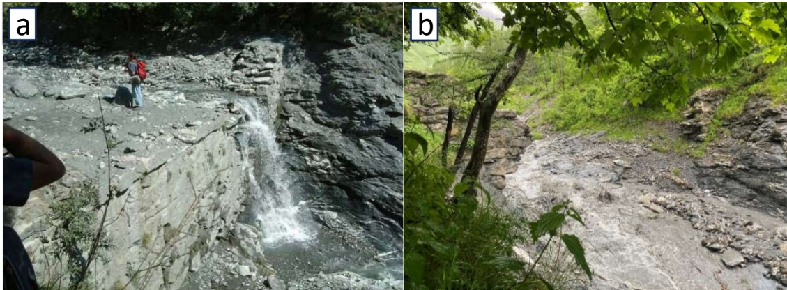
Figura 3.24: Barriera trasversale 3, in pietrame. a) danneggiamento a seguito dell'evento del 2004, b) briglia completamente distrutta a seguito dell'evento del 2023
