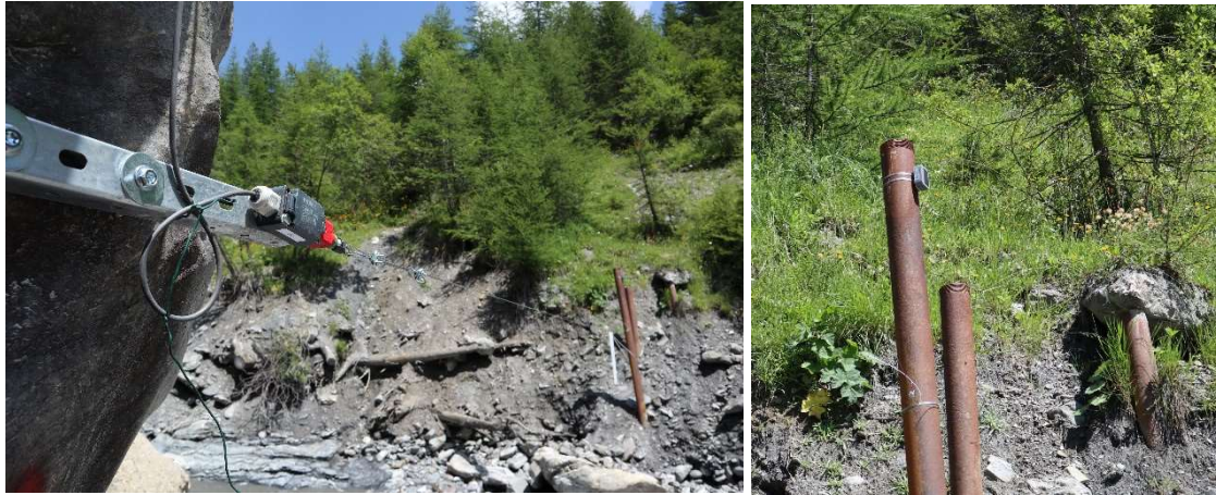
Figura 5.14: Cavo a strappo e accelerometro ACM5 installati in corrispondenza della briglia 02
