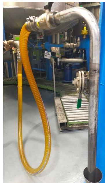
Figura 52 – Residui di materiale nel flessibile di aspirazione
