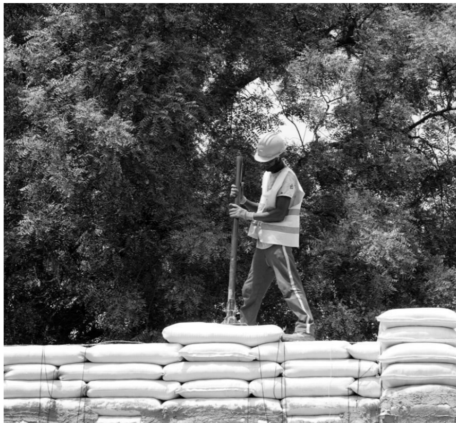
Figura 7: Costruzione del centro polivalente di Tanaff (in corso). Fonte immagine: https://www.balouosalo.com/architetture.html (ult. cons. 20/06/2024)
