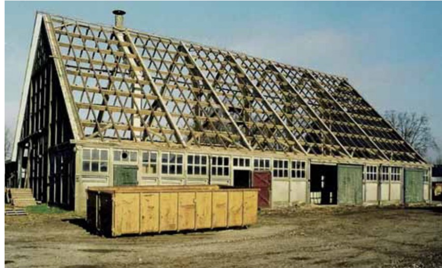
Fig 89 – Schokbetonschuur, first large-scale application of concrete prefab barn in Noorddoostpolder. Source – Schokbetonschuur monument voor wederopbouw. Wageningen University & Research. https://edepot.wur.nl/13039
