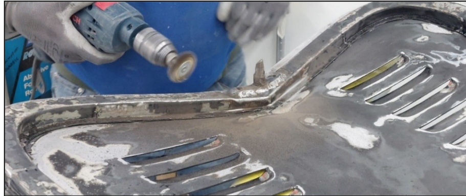
Figura 7.6. Rimozione della corrosione dal telaio in acciaio del cofano anteriore tramite l'utilizzo di spazzola metallica rotante. Il telaio del cofano è caratterizzato da una sezione a U e lungo il perimetro la lamiera di alluminio è ancorata al lembo esterno tramite cianfrinatura .
