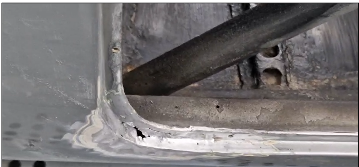
Figura 4.6. Corrosione perforante dell'alluminio lungo il profilo inferiore del vano porta destro. Si può notare anche un tubo in acciaio del telaio.
