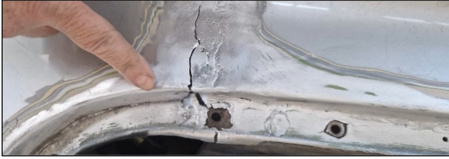
Figura 5.7. La cricca prima della riparazione. Sotto si nota la ripiegatura ( cianfrinatura ) dell'alluminio della scocca sul bordo della paratia in acciaio del vano motore, rigidamente collegata al telaio tubolare.
