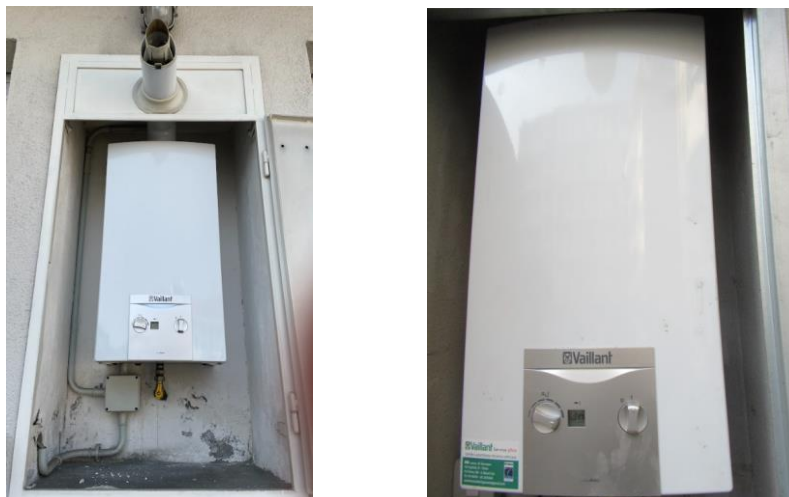
Figura 31 - Esempi di caldaie a gas metano per la produzione autonoma di ACS - immagini da sopralluogo
