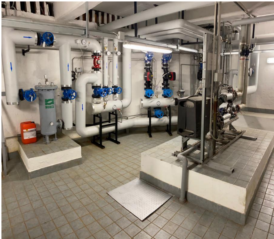
Figura 29 - Centrale termica condominiale riqualificata nel 2021 - immagine da sopralluogo
