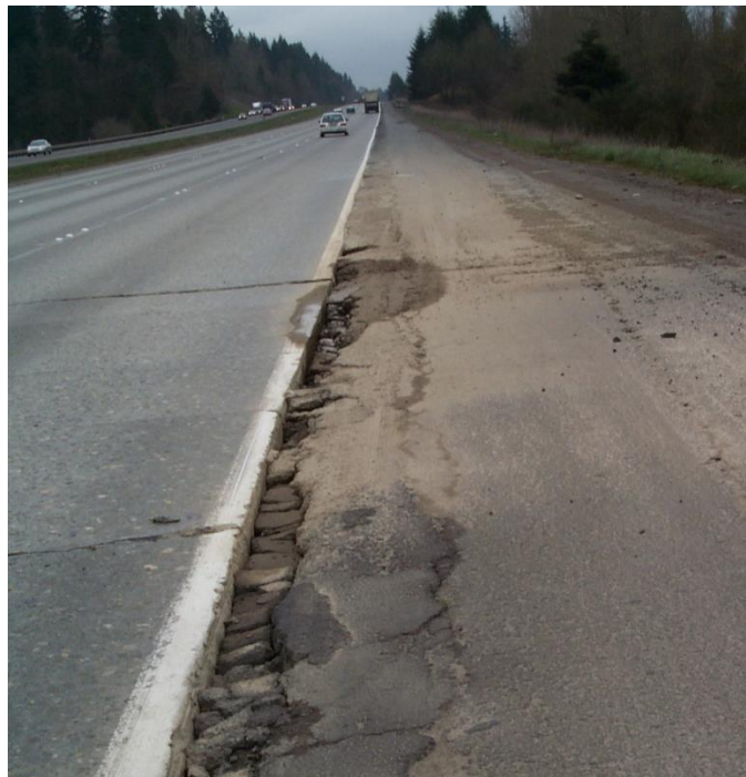
Figura 43 Dissesto per pumping [28]
