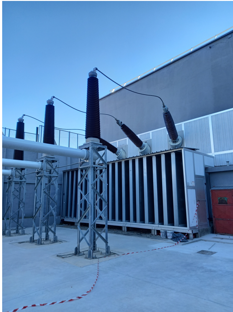
Figura 4.4: Terminali in aria dei trasformatori AT/MT stazione SUD
