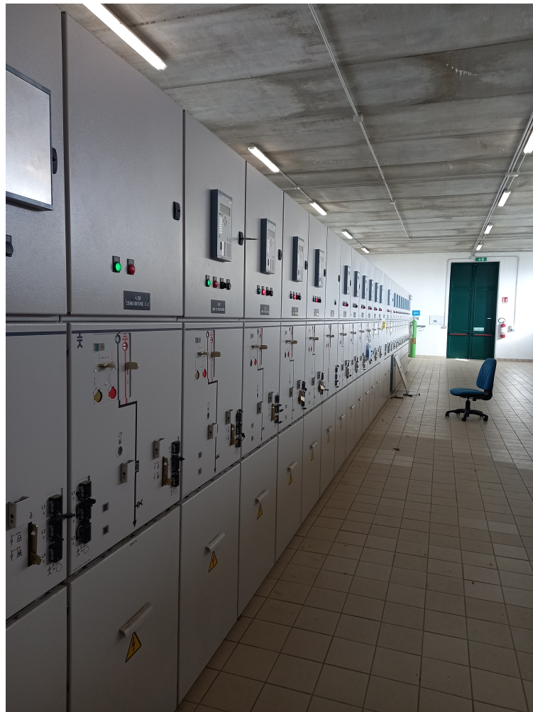
Figura 4.27: Quadro MT stazione SPIP
