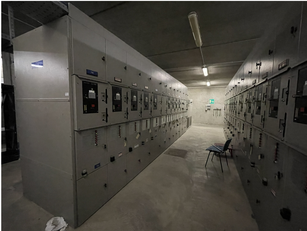
Figura 4.20: Quadri MT stazione SUD-OVEST
