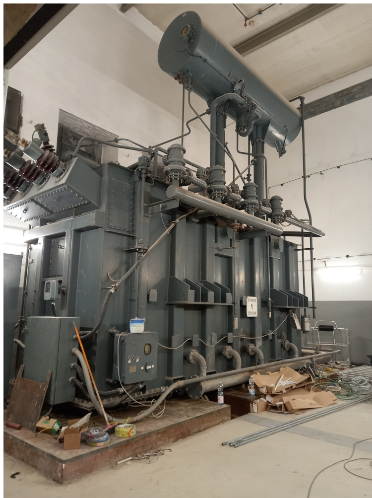
Figura 4.3: Trasformatore AT/MT stazione SUD
