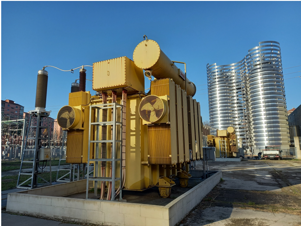
Figura 4.18: Trasformatore AT/MT stazione SUD-OVEST
