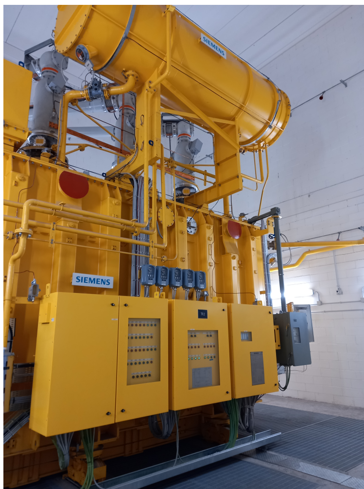
Figura 4.10: Trasformatore AT/MT stazione ARBARELLO
