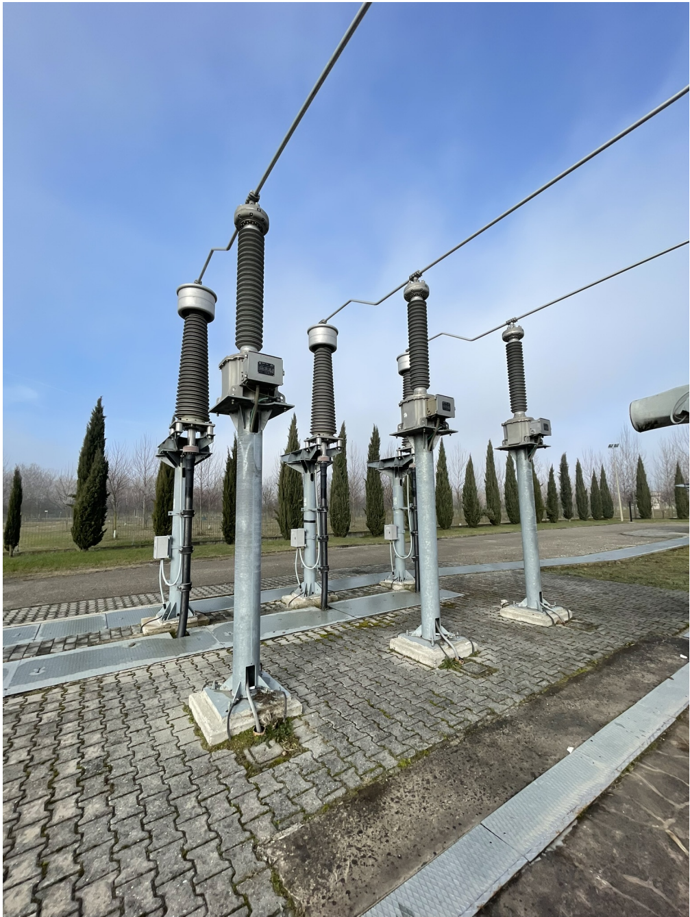
Figura 4.30: Arrivo cavi AT stazione SPIP
