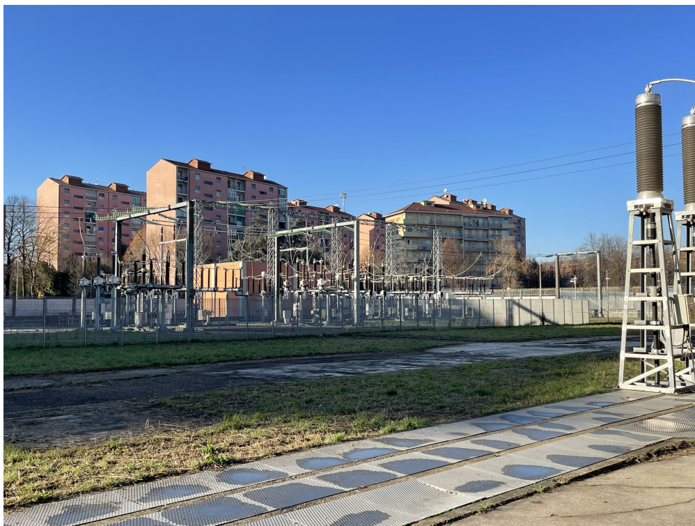
Figura 4.21: Arrivo linea AT da stazione Terna a stazione SUD-OVEST
