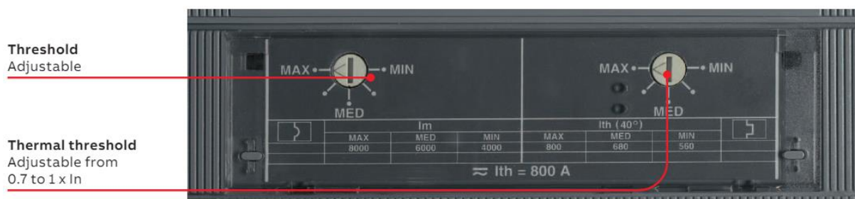
Figura 90: Pannello per le regolazioni dell'interruttore magnetotermico
